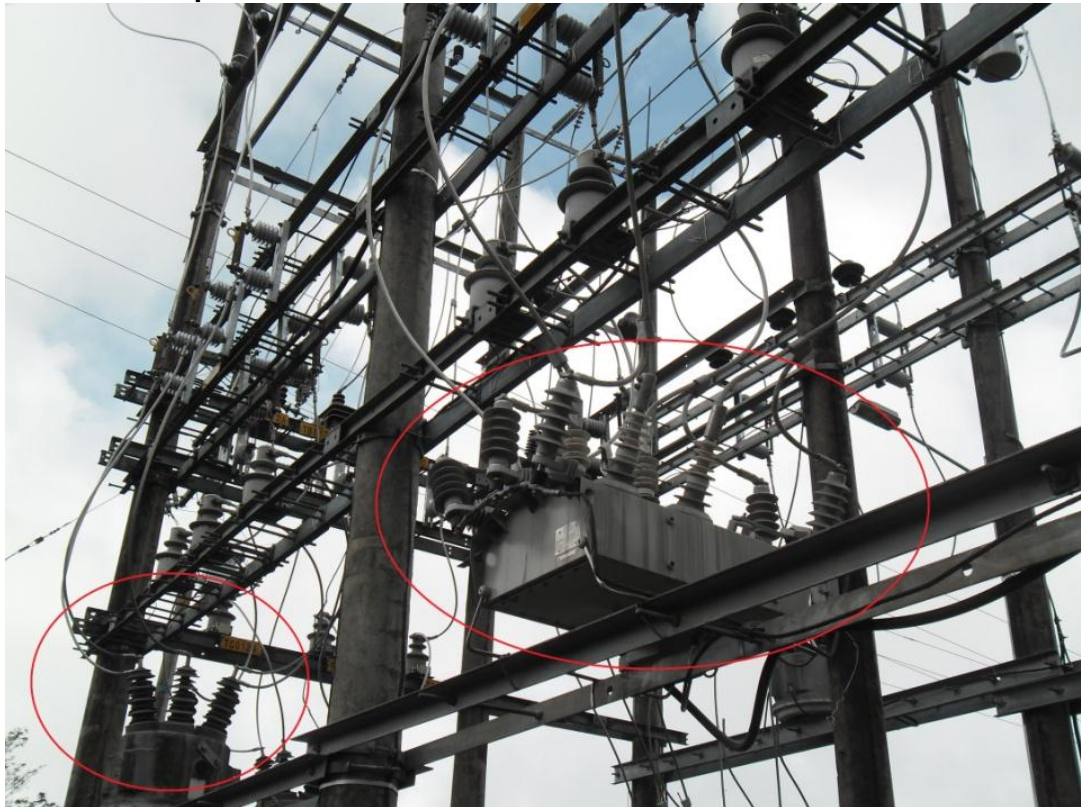
Figura 68. Interruptor de cabecera
