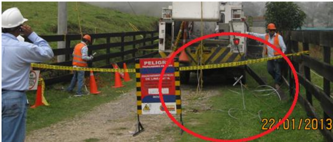
Figura 24. Conexión a tierra del vehículo
