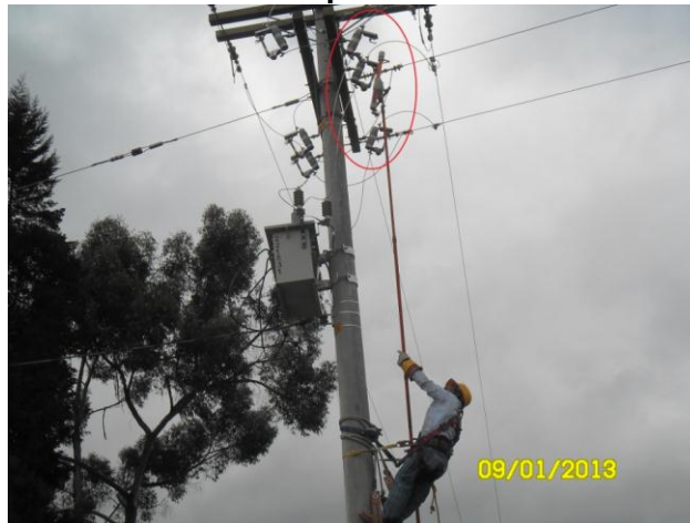
Figura 15. Apertura de un seccionador tipo fusible con load buster
