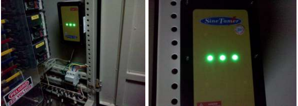
Figura 8. DPS SineTamer, subestación eléctrica.
