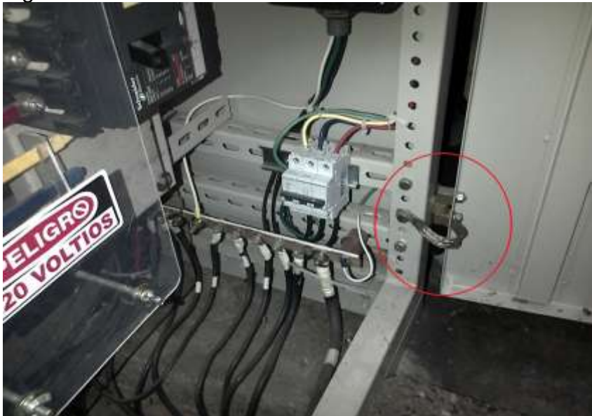
Figura 7. Protección del armario de la subestación eléctrica.
