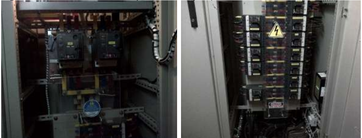
Figura 6. Subestación eléctrica parte inferior y superior.
