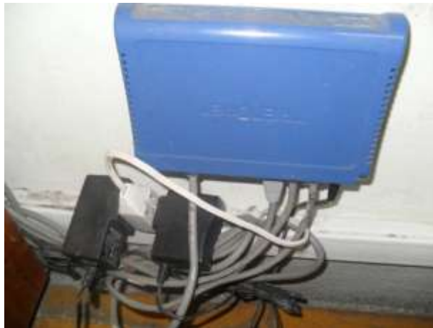
Figura 37 Switch ubicado en la coordinación.
