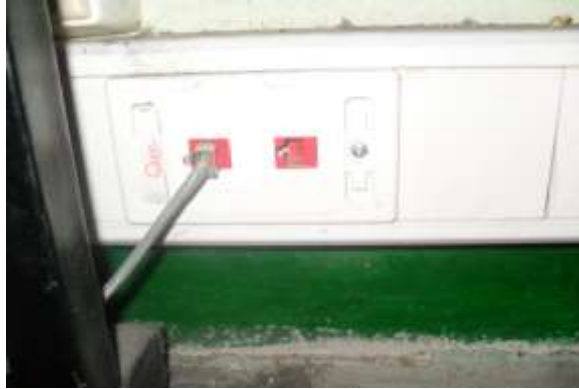
Figura 31 Puntos de red de la sala de sistemas segundo piso.
