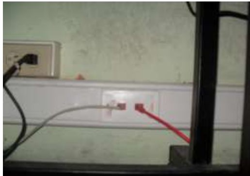
Figura 27 Puntos de potencia del tablero regulado y puntos de red de la sala de sistemas primer piso
