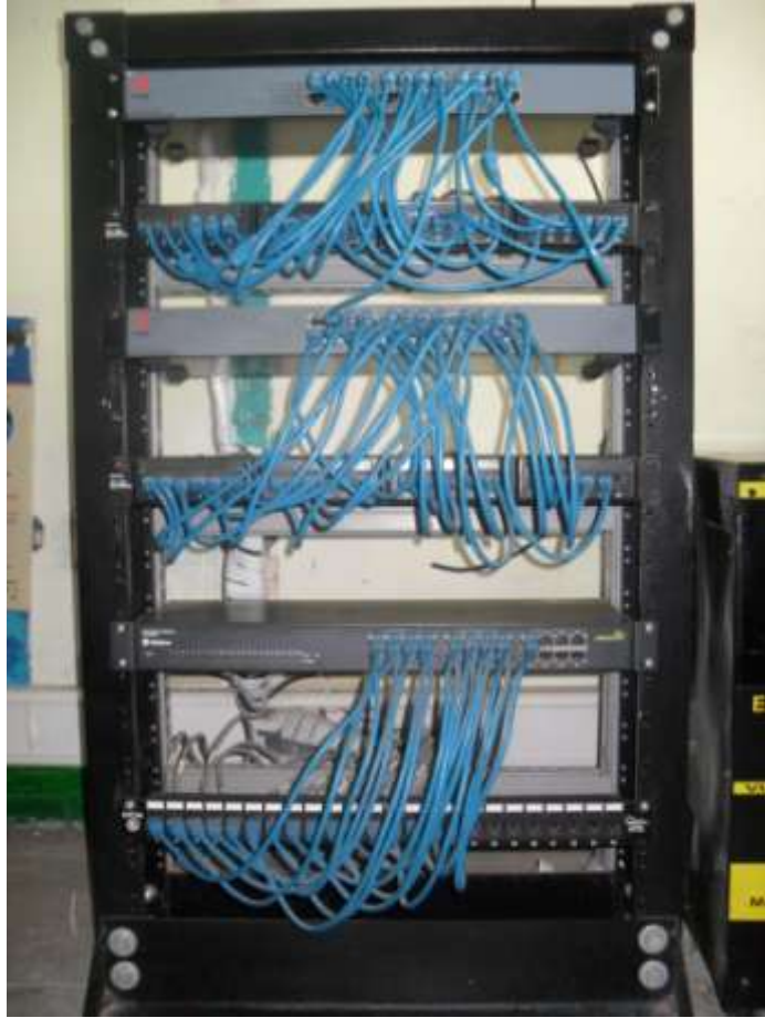
Figura 34 Rack ubicado en la sala de sistemas del segundo piso.
