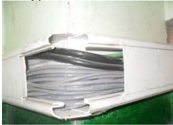
Figura 24 Canaleta datos y potencia
