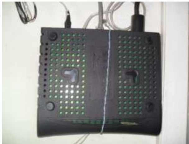
Figura 38 Modem ubicado en la coordinación
