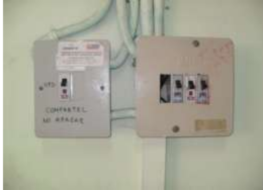
Figura 26 Tablero de distribución general con 3 circuitos y tablero regulado.
