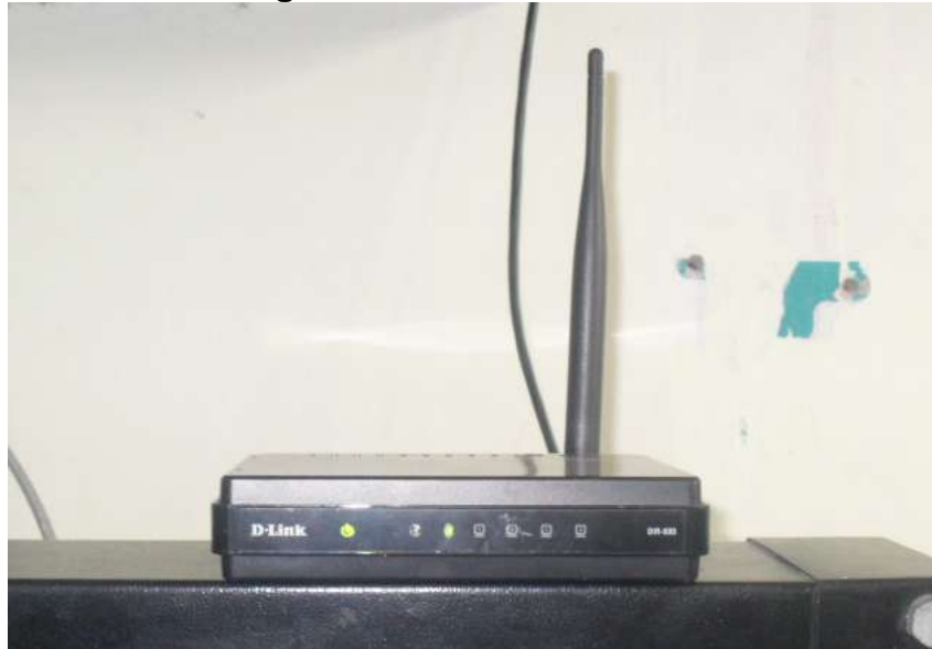
Figura 40 Router al cual llega el servicio.
