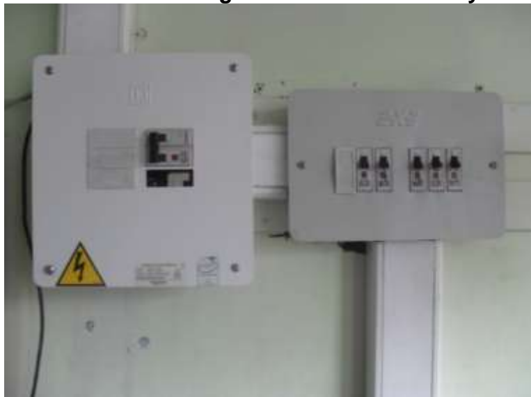
Figura 30 Tablero de distribución general con 5 circuitos y tablero regulado.
