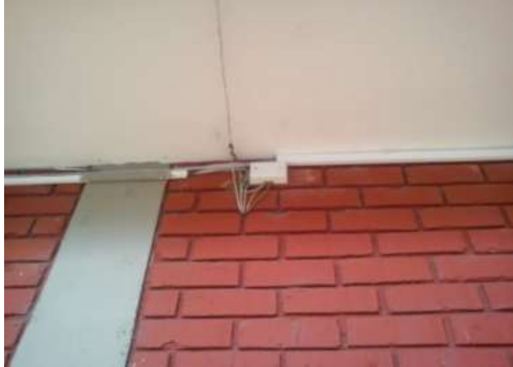
Figura 31. Cable sin canaleta.
