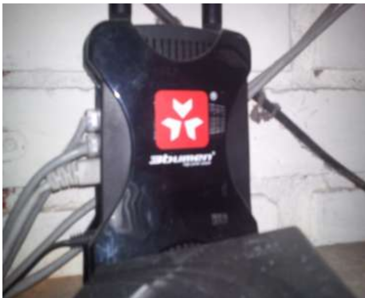
Figura 35. Access Point sistemas 1.
