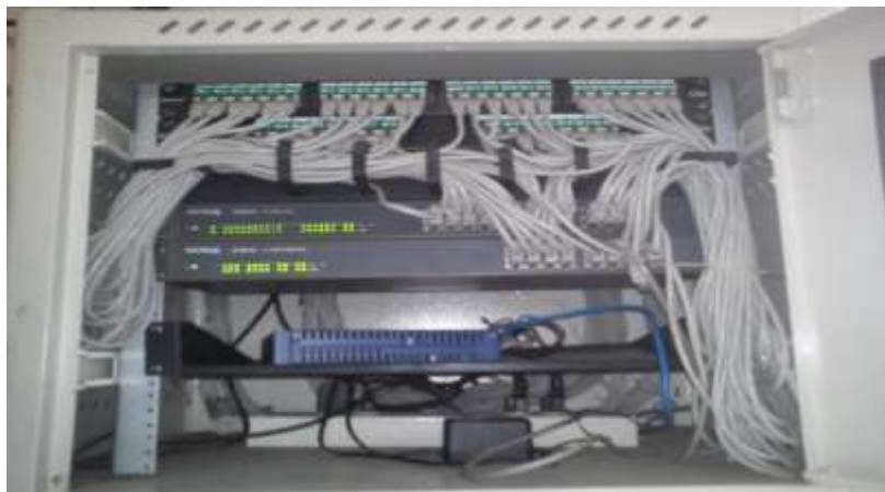
Figura 34-Gabinete sala de sistemas 1
