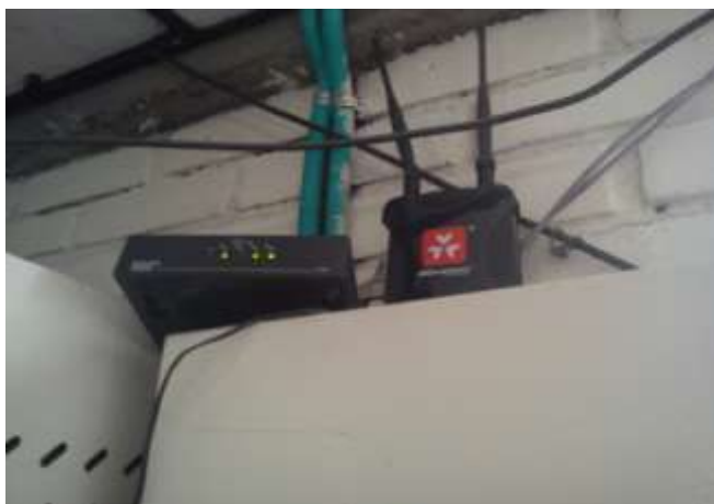
Figura 29. Modem y Access point en la sala de sistemas 1
