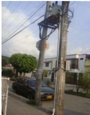
Figura 41. Puesta a tierra del transformador
