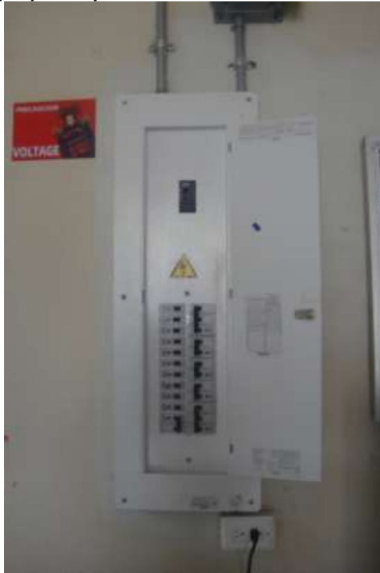
Figura 18. Tablero principal primer piso
