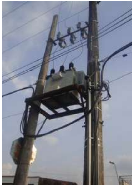
Figura 39. DPS y bujes del transformador.
