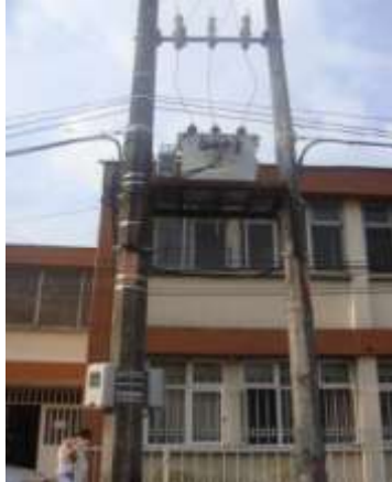
Figura 40. Transformador de fácil acceso para mantenimiento
