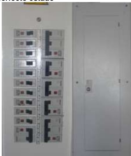
Figura 34. Interruptores en perfecto estado
