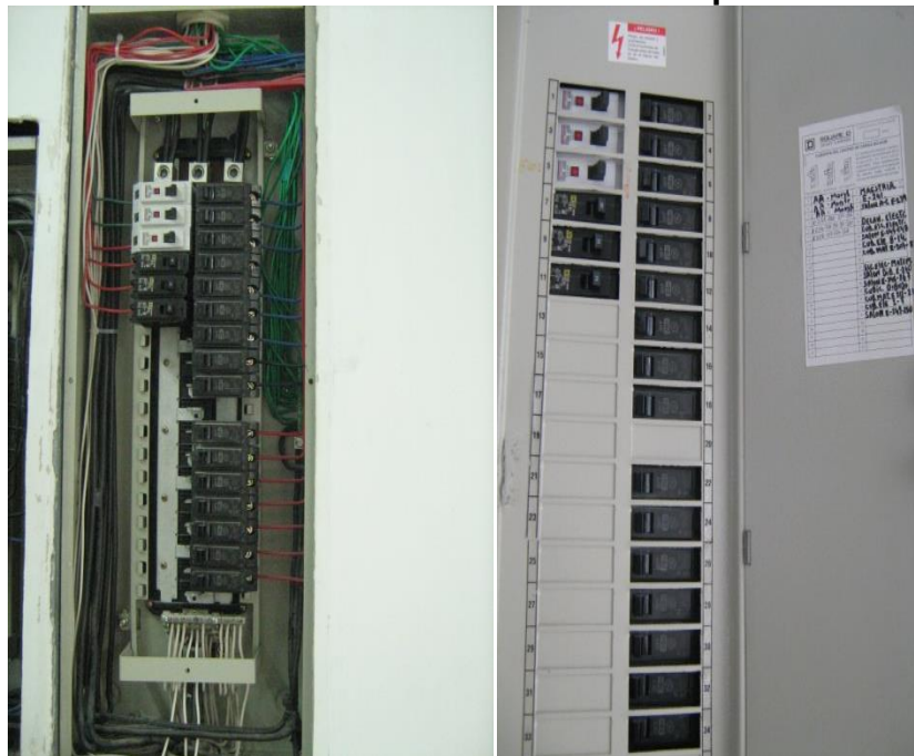
Figura A 58. Tablero Normal Alumbrado corredor bloque E hacia bloque A
