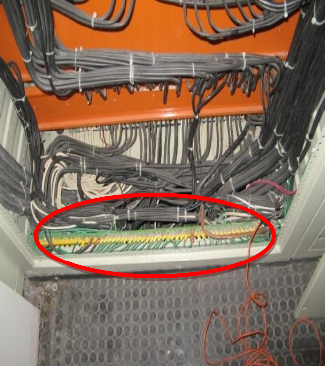
Figura A 12. Conexión equipotencial tablero principal.
