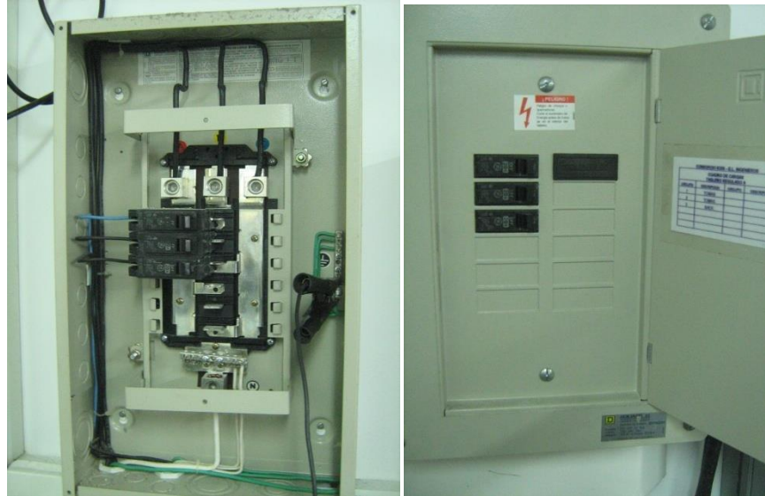
Figura A 51. Tablero Normal #09 E-126
