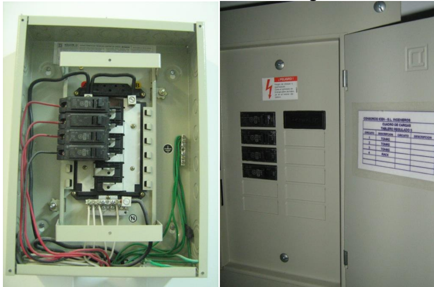
Figura A 61. Tablero Normal Laboratorio de investigación E-244
