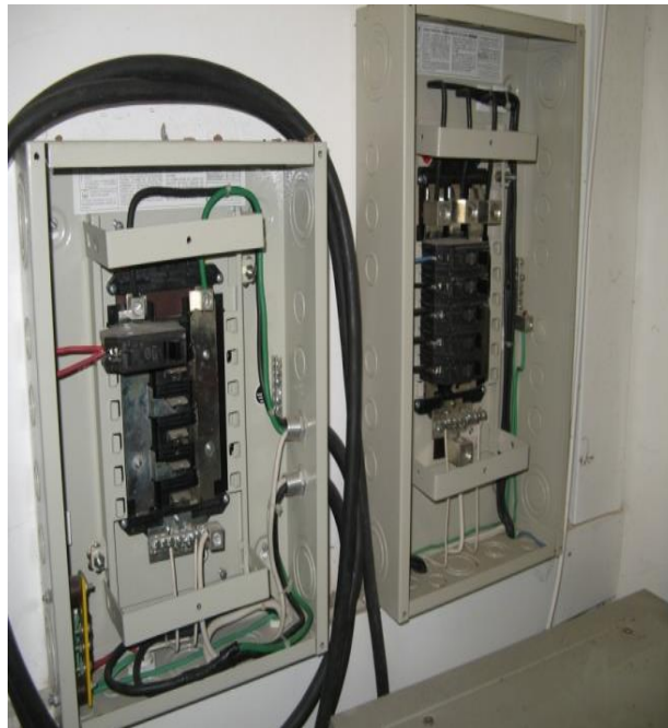
Figura A 43. Disposición de conductores tablero regulado #13 Sala de Mantenimiento E-123
