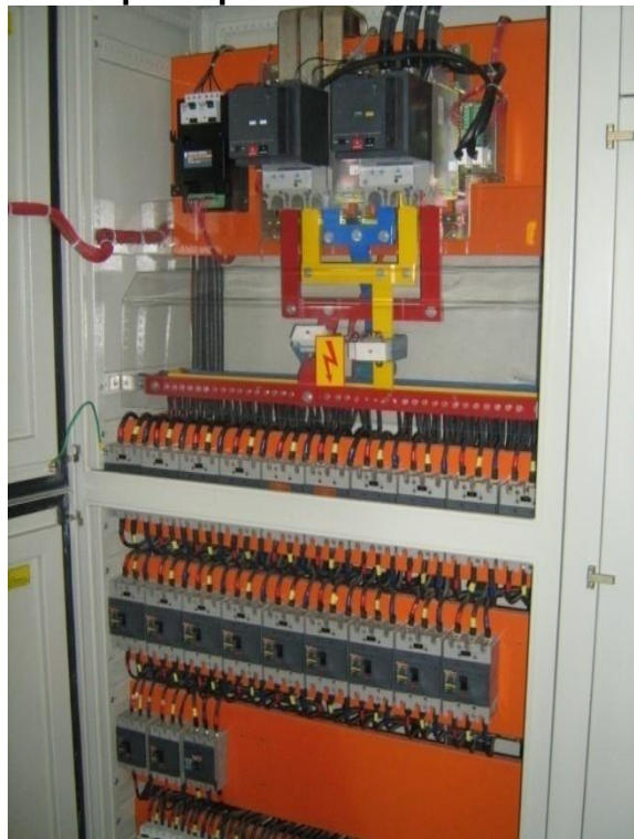
Figura A 8. Tablero cuarto principal.
