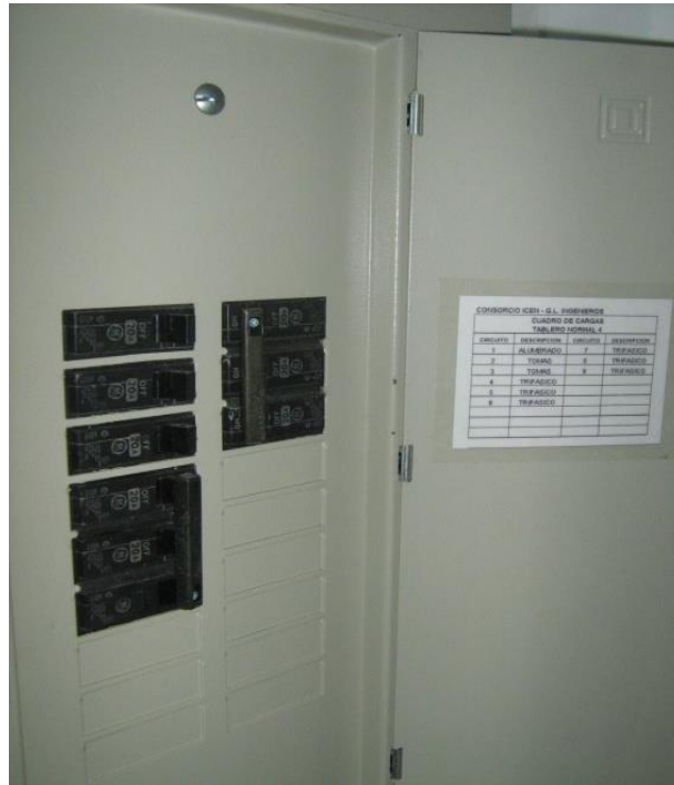
Figura A 23. Tablero normal #4 E-114
