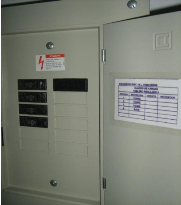
Figura A 29. Tablero regulado #5 Multimedia I - E-113
