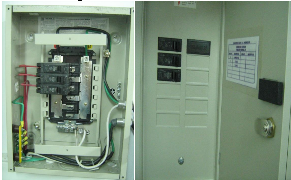
Figura A 52. Tablero regulado #09 E-126
