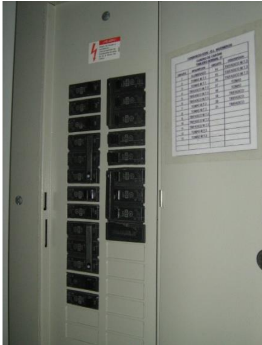
Figura A 19. Tablero normal #17 Laboratorio de Circuitos E-115
