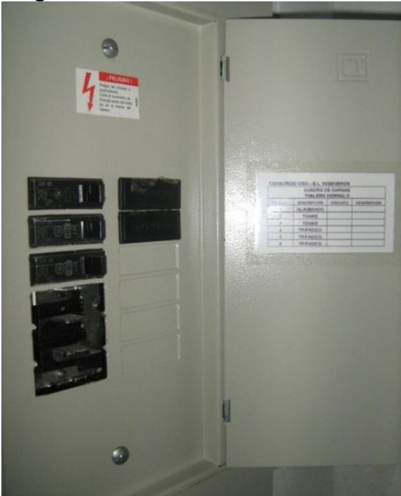
Figura A 33. Tablero regulado #6 Multimedia II E-112
