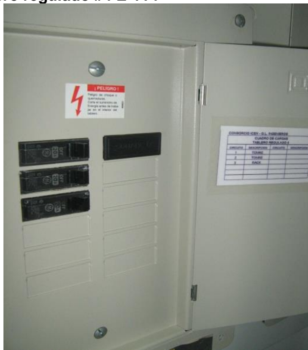
Figura A 25. Tablero regulado #4 E-114
