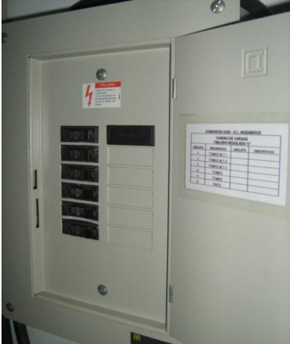
Figura A 21. Tablero regulado #17 Laboratorio de Circuitos
