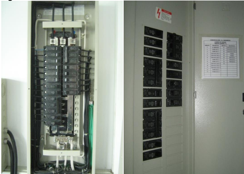
Figura A 47. Tablero normal #14 Laboratorio de Medidas E-124
