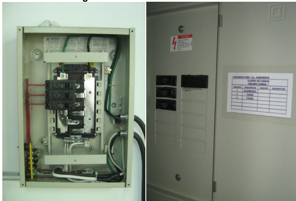
Figura A 56. Tablero Regulado #07 E-104
