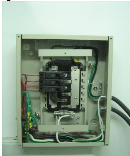
Figura A 50. Tablero regulado #11 Taller Líneas de Transmisión E-107
