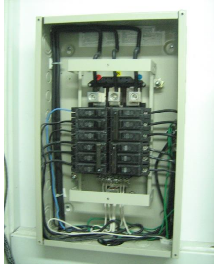
Figura A 49. Tablero Normal #11 Taller Líneas de Transmisión E-107
