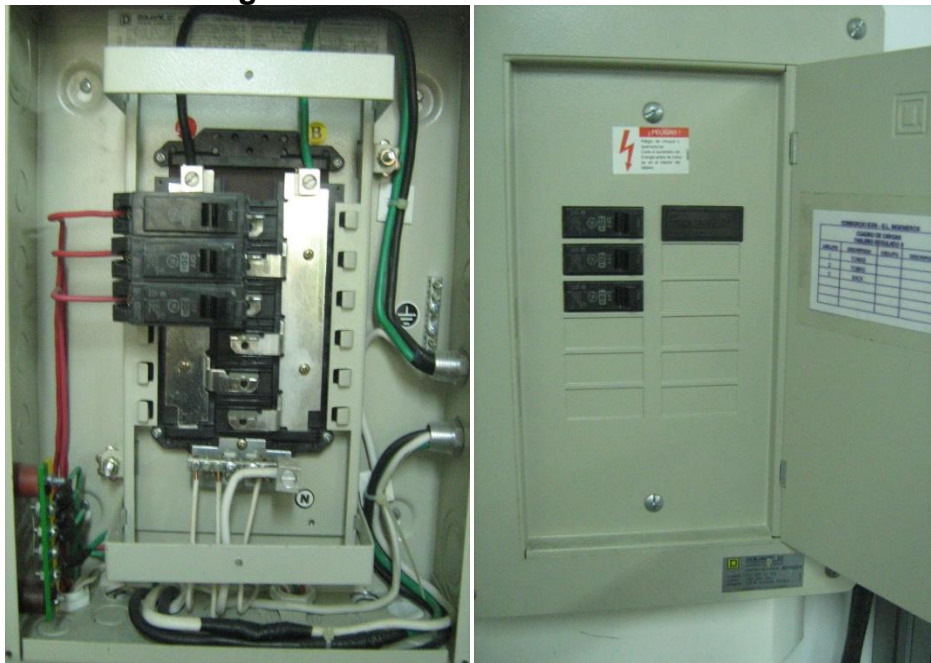
Figura A 54. Tablero Regulado #08 E-105
