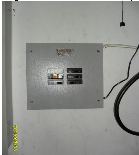
Figura A 17. Tablero regulado #2 del laboratorio de máquinas
