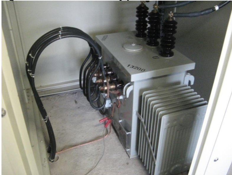
Figura A 2. Transformador y puesta a tierra del transformador.
