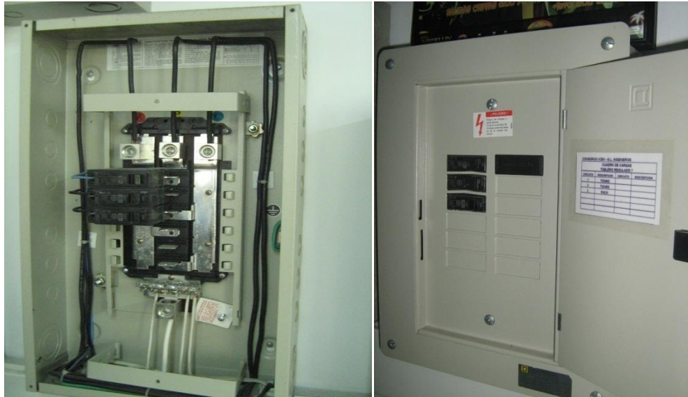
Figura A 55. Tablero Normal #07 E-104
