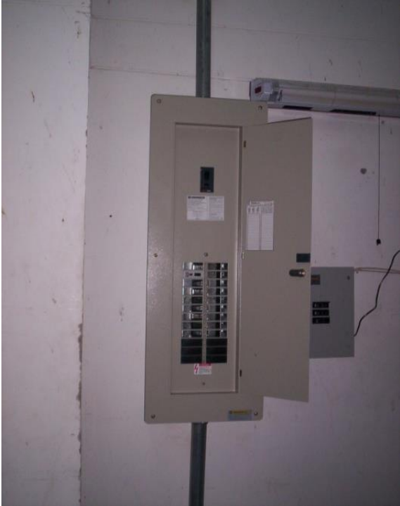
Figura A 15. Tablero normal #2 Laboratorio de Maquinas
