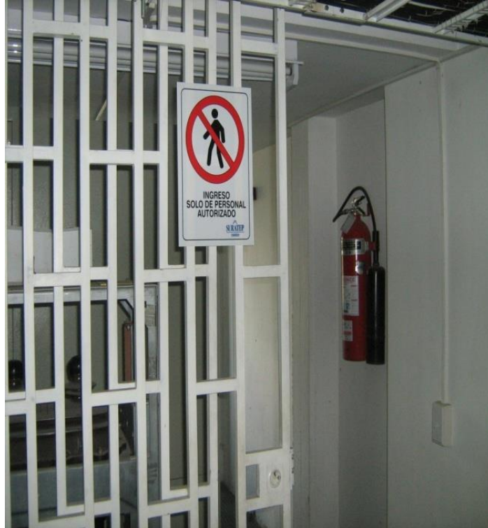
Figura A 5. Entrada principal cuarto eléctrico desde el interior.
