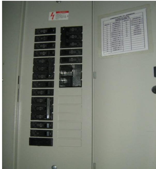
Figura A 35. Tablero normal #16 Laboratorio de Electrónica E-117
