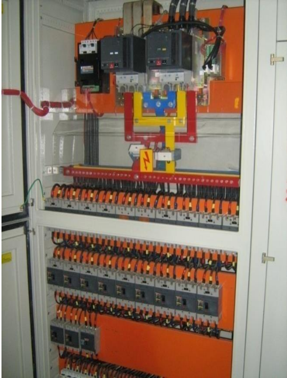
Figura A 10. Tablero cuarto principal.
