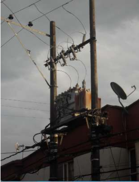
Figura 11. Transformador tipo poste en H
