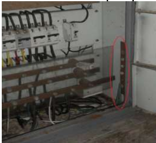
Figura 18. Puesta a tierra Gabinete eléctrico principal
