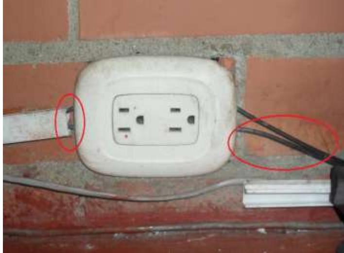
Figura 24. Cable inadecuado (cable dúplex)
