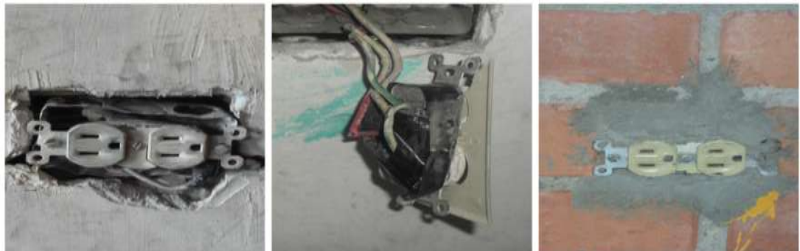
Figura 22. Estado de tomacorrientes
