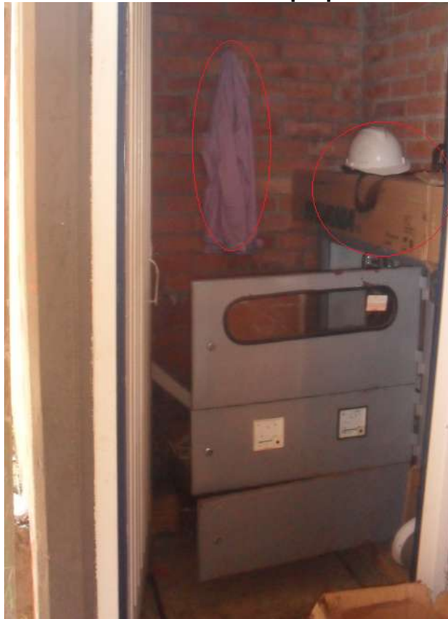
Figura 15. Almacenamiento de elementos inapropiados
