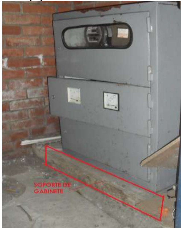
Figura 14. Soporte de equipos
