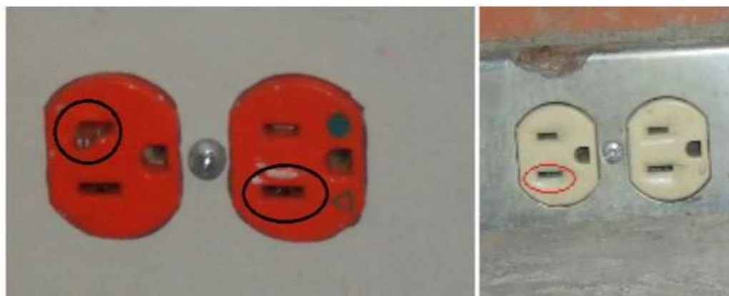
Figura 23. Estado de tomacorrientes
