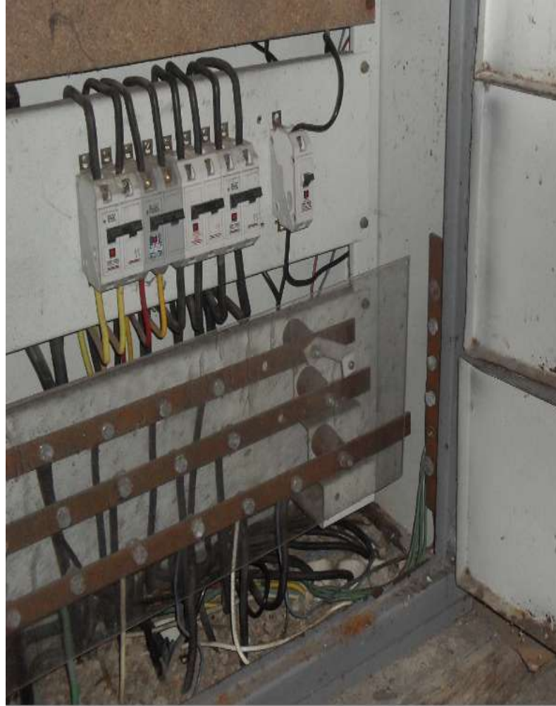
Figura 16. Espacio en tablero principal.
