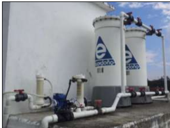
Planta de tratamiento de la vereda La Cumbre.
