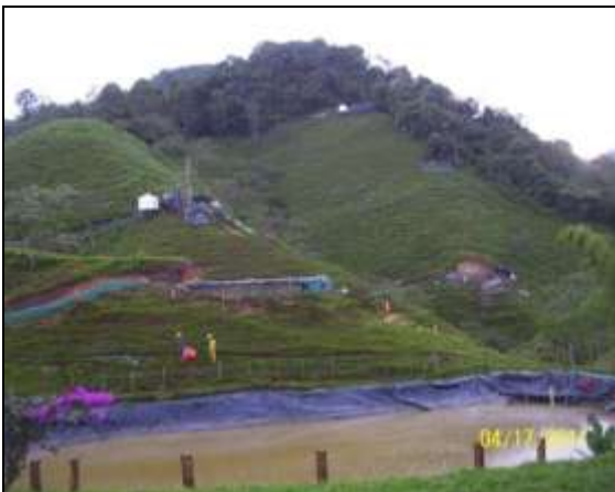
Plataforma en operación.
