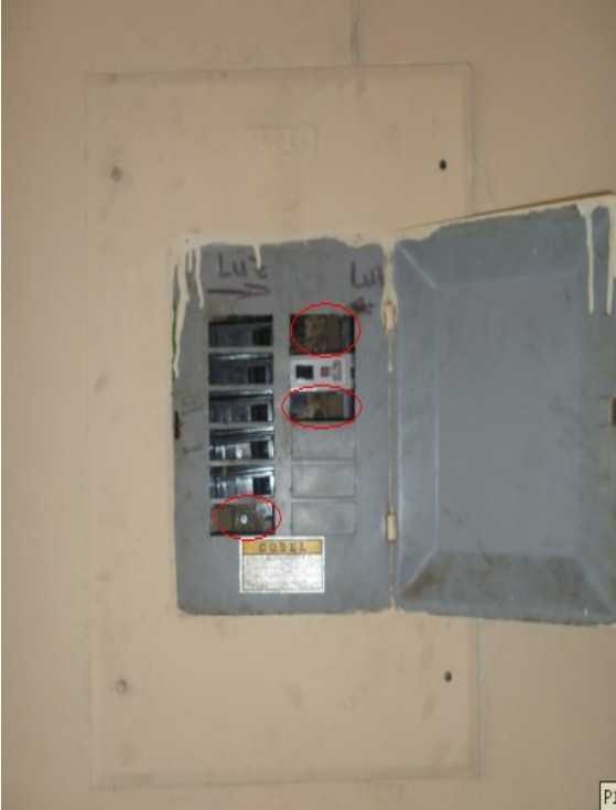
Figura 16. Tablero piso 2 B.
