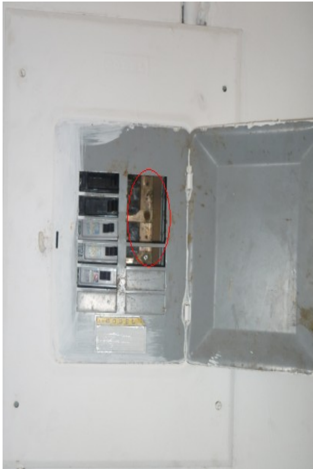
Figura 19. Tablero piso 3 A.
