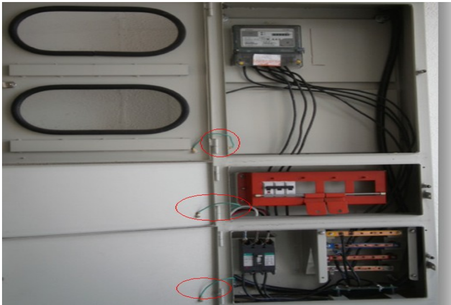
Figura 4. Gabinete eléctrico principal.
