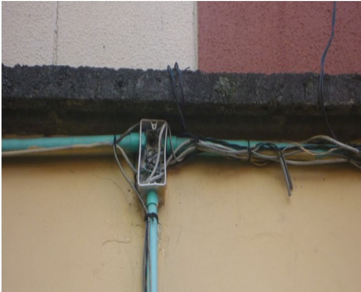
Figura 21. Caja de paso.
