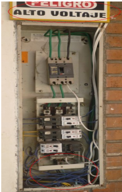
Figura 14. Tablero general B.
