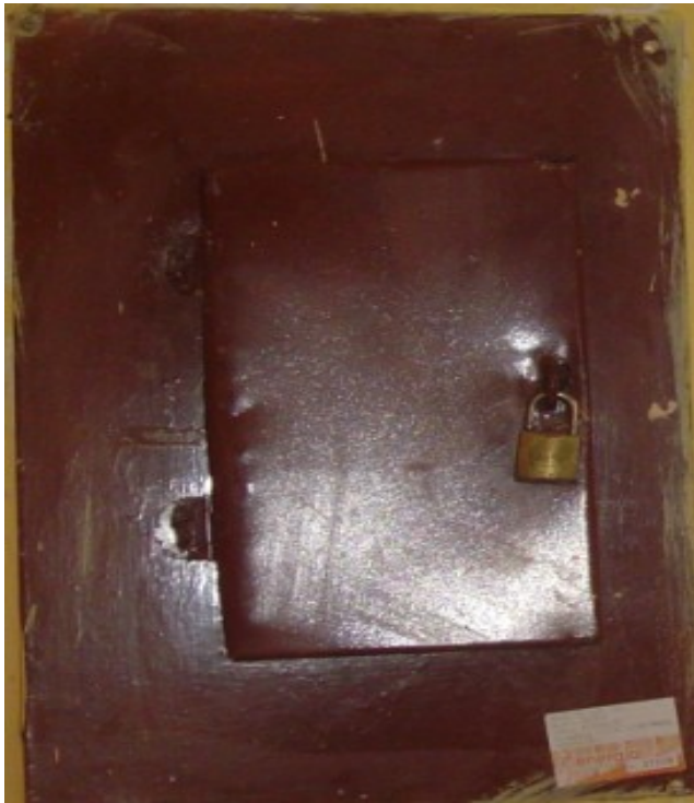
Figura 8. Tablero principal A.
