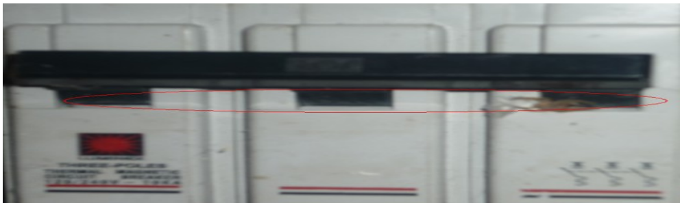
Figura 6 . Palanca de accionamiento del interruptor.
