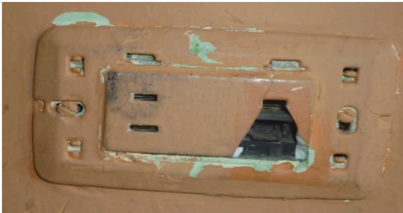
Figura 24. Toma en mal estado.
