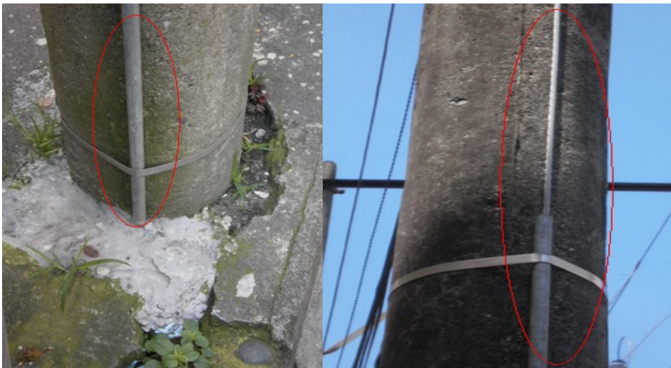
Figura 3. Conductor de puesta a tierra del Transformador
