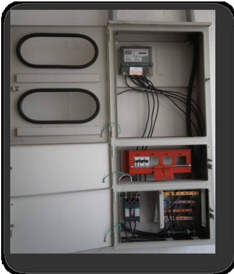
Figura 5. Gabinete eléctrico principal A.
