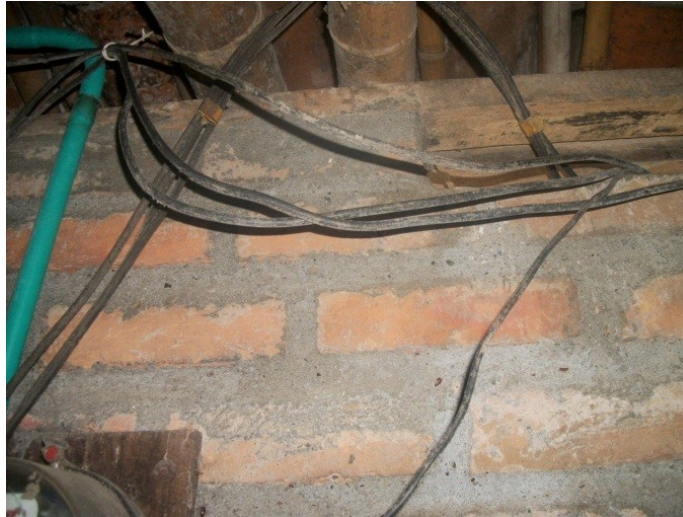
Figura. 18 Conductos de la acometida en el interior del silo.
