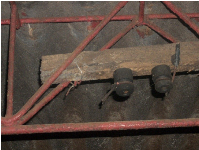
Figura. 16 Aislamientos de los conductores con la estructura.
