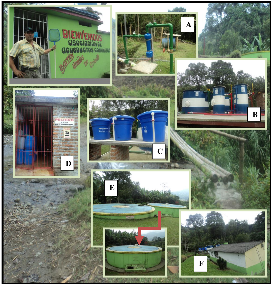
Foto 10: Componentes del sistema de tratamiento y distribución del recurso hídrico A.A.C. la Mariana. En su orden se presentan: Tubería entrega agua captada (A), tanques de tratamiento (B y C), caseta de almacenamiento insumos (D), casetas de cloración (D ), tanques de almacenamiento (E) e instalaciones casa del fontanero de planta y familia (F). Fuente: Propia (2012)
