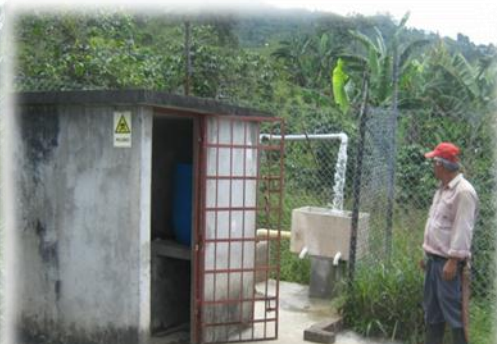
Planta de tratamiento A.A.C. Nueva Colombia
