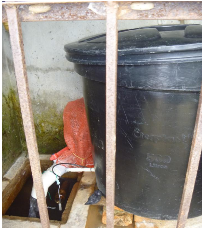
Foto 11: Tanque de cloración sistema de acueducto comunitario la Rivera. Fuente: Bravo (2011)
