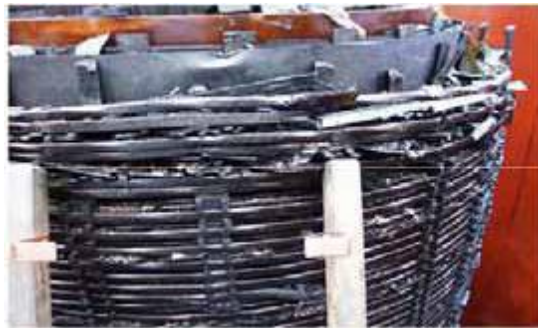
Figura No. 32. Transformador con falla de devanados [42].
