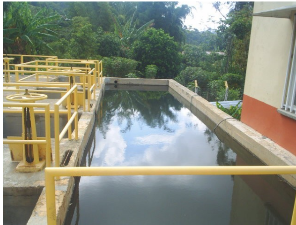
Fotografía 7. Planta de Potabilización Apia
