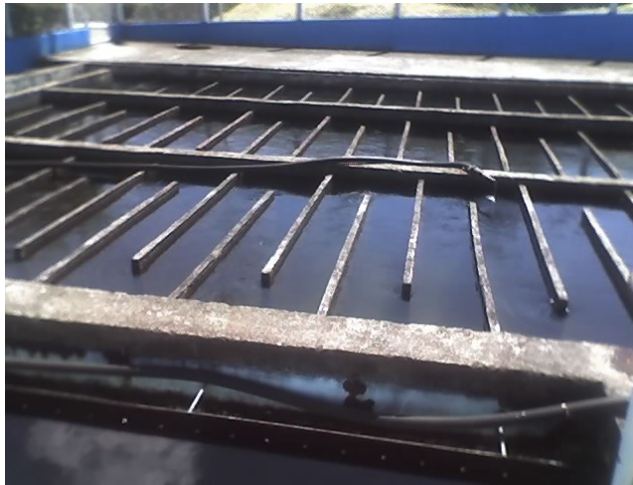
Fotografía 5. Planta de Potabilización Belén de Umbría
