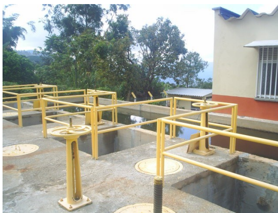
Fotografía 1. Planta de Tratamiento de Agua Potable Apia
