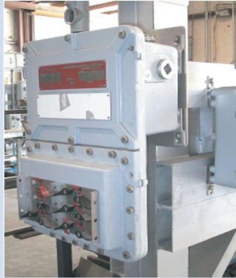
Figura 501-15 Tablero contra explosiones.
