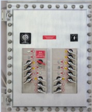
Figura 502-33 Estación de control.
