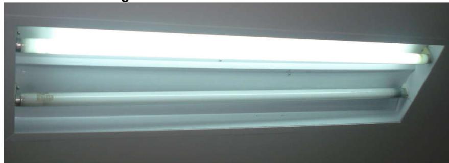
Figura 23. Luminaria con tubo dañado.
