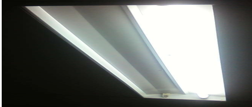
Figura 26. Luminaria con tubo con bajo flujo luminoso y tubo dañado.
