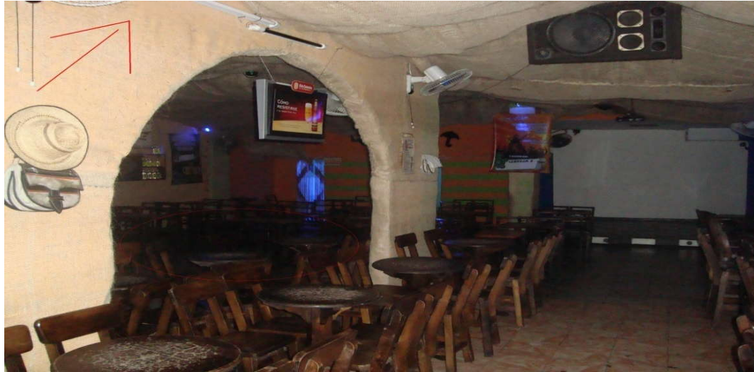
Foto No. 3 Establecimiento con paredes recubiertas con fibra de fique, instalaciones eléctricas descubiertas y gran concentración de sillas y mesas.
