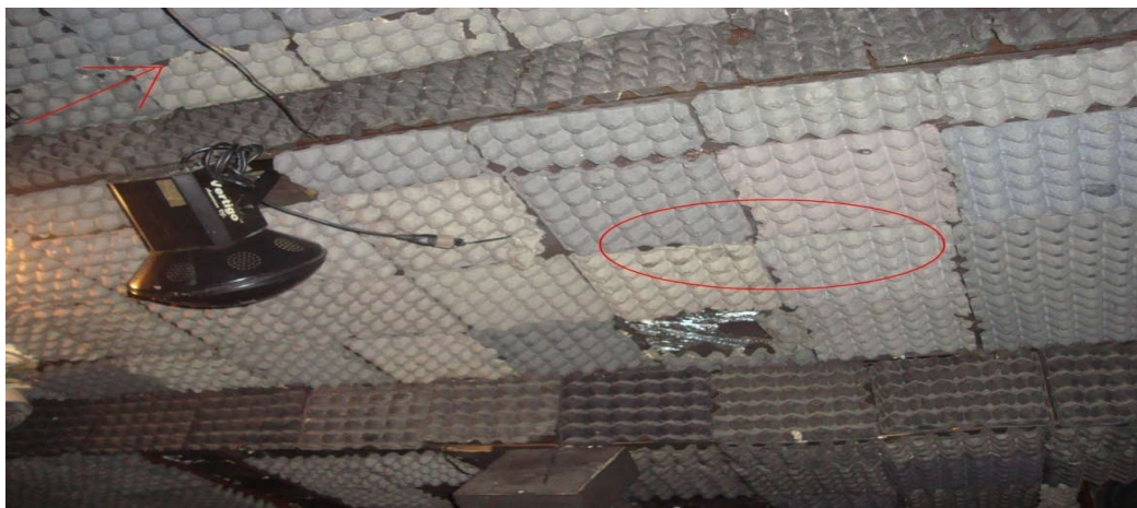
Foto No.2 Establecimiento con cielorraso cubierto con paneles donde se empacan los huevos en combinación con las instalaciones eléctricas descubiertas.
