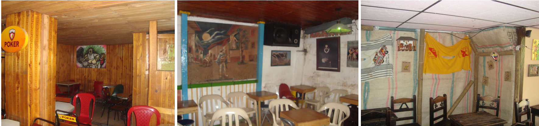
I. Establecimientos visitado donde se visualiza la presencia de materiales combustibles en techo, paredes, sillas y mesas.
