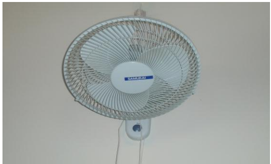
Figura 33: Ventilador de la sala de sistemas
