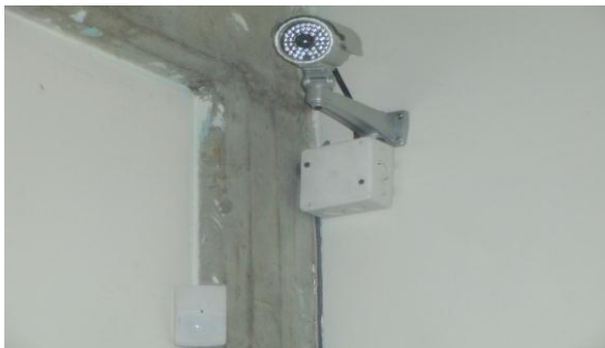
Figura 36: Cámara de seguridad (infrarrojo detección de movimiento)
