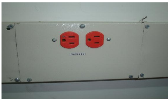
Figura 18: Puntos de potencia del tablero regulado y no regulado
