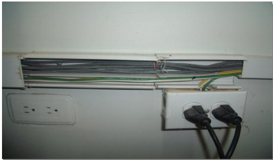
Figura 32: Distribución de cableado
