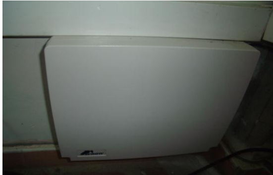
Figura 34: Caja para la alarma
