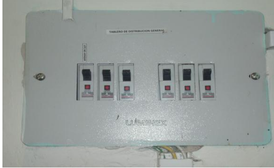
Figura 15: Tablero de distribución general con 6 circuitos.
