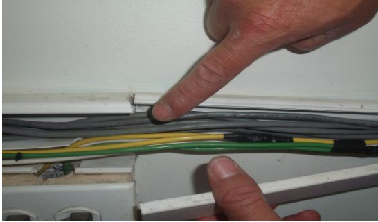
Figura 31: Red de potencia y datos sin separador
