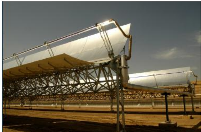
Figura 24. Colectores Cilindro Parabólicos y sus Características
