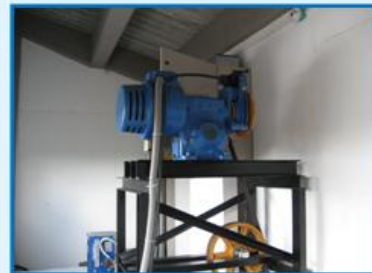
Figura 620-17. Cuarto de máquinas de un ascensor.
