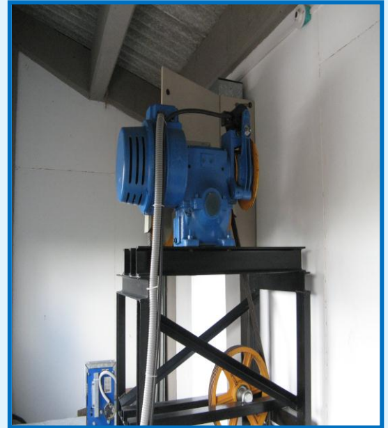
Figura 620-17. Cuarto de máquinas de un ascensor.
