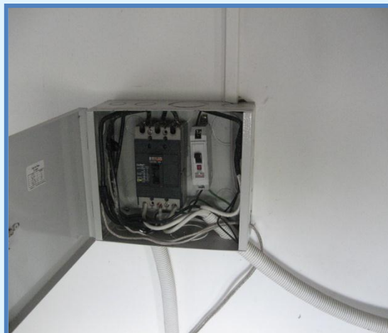
Figura 620-23. Medio de desconexión de un ascensor.
