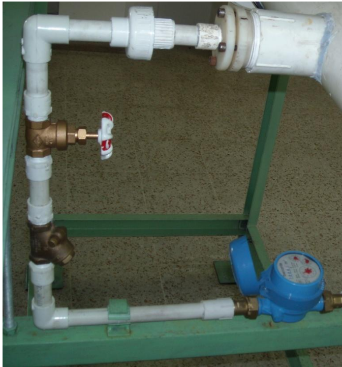
Fotografía 3. Entrada de Agua del medidor proporcional
