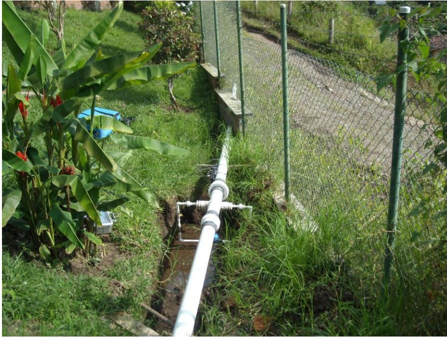
Fotografía 2. Medidor de agua de tipo proporcional instalado en campo
