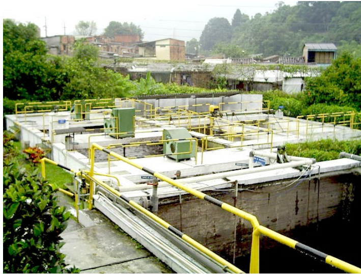
Fotografía No.9 PTAR
