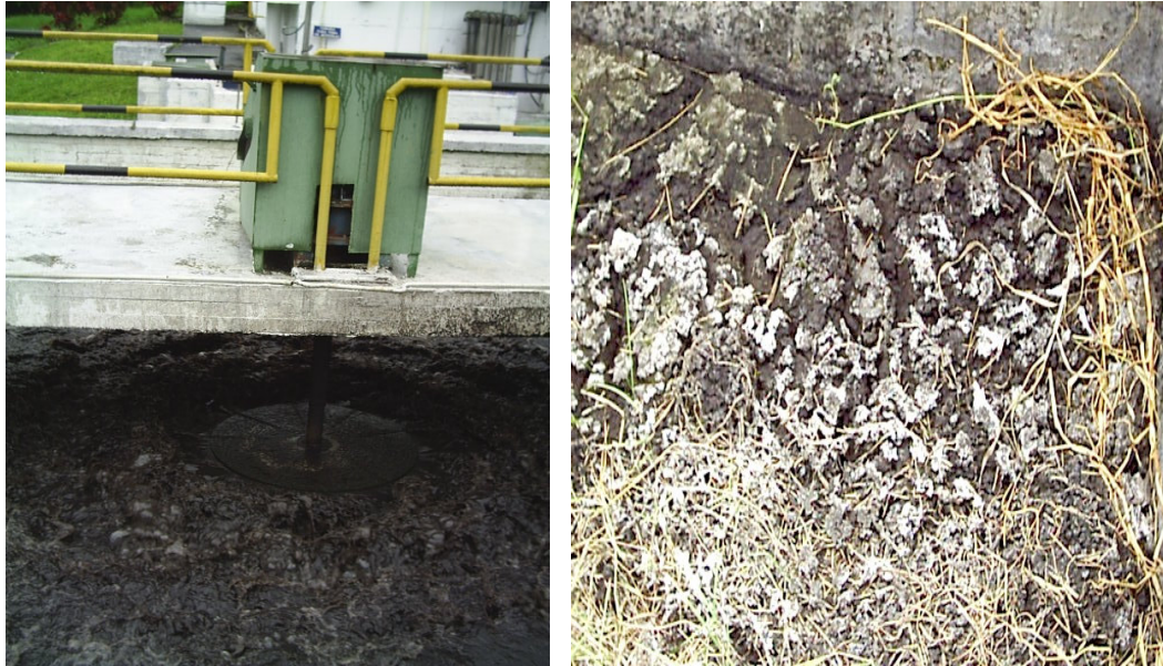
Fotografía No.10 Reactor de Lodos Activados y Lecho
