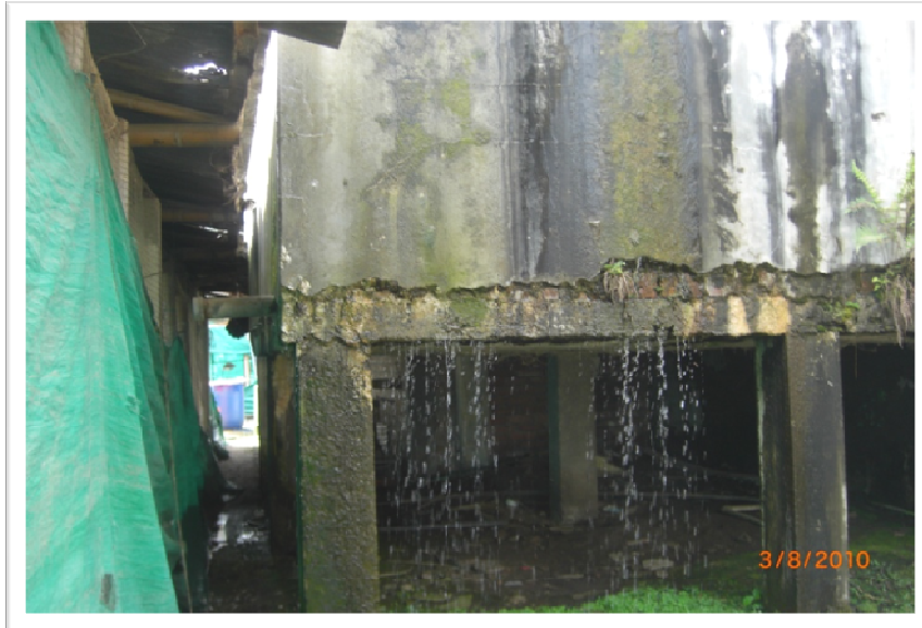
Foto 16. Falta de Control en el Manejo del Agua
