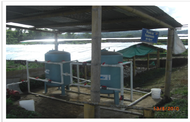
Foto 6. Filtros de Tratamiento de Agua
