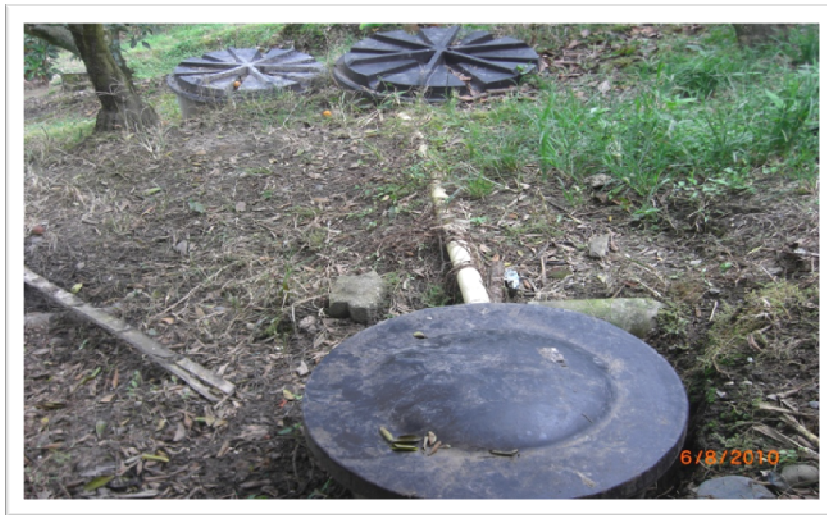
Foto 9. Tanque Séptico Aguas Residuales Domesticas.
