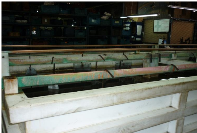
Foto No.23 Tanque galvanizado
