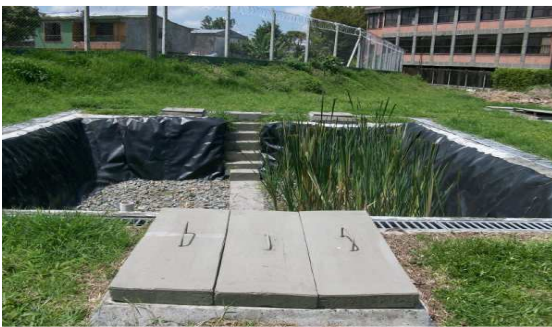
Fotografía 19. Planta de tratamiento de aguas residuales (Humedal Artificial).
