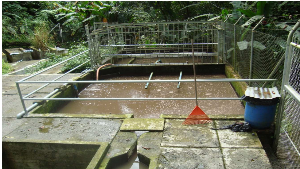
Planta de tratamiento Universidad Tecnológica de Pereira.
