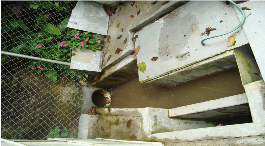
Desarenador (Pretratamiento del agua residual)
