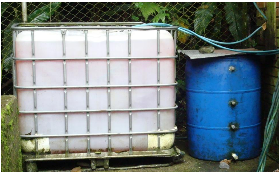
Foto 7: tanques de alimentación principales; blanco alimenta humedales 1 y 2 (capacidad 1000 l) Azul alimenta humedal 3 (capacidad 200 l)
