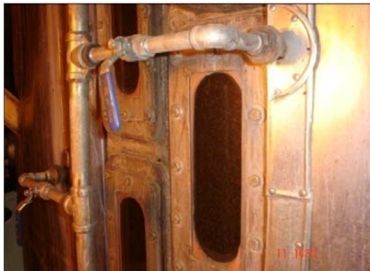
Figura 4. Mirillas de sedimentación del clarificador
