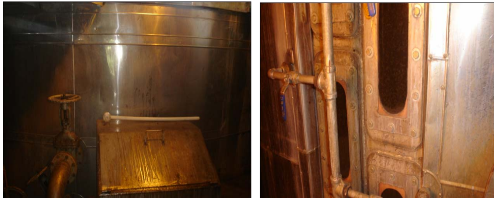
Figura 1. Equipos para reacción y sedimentación. IRISA-ELABORACION
