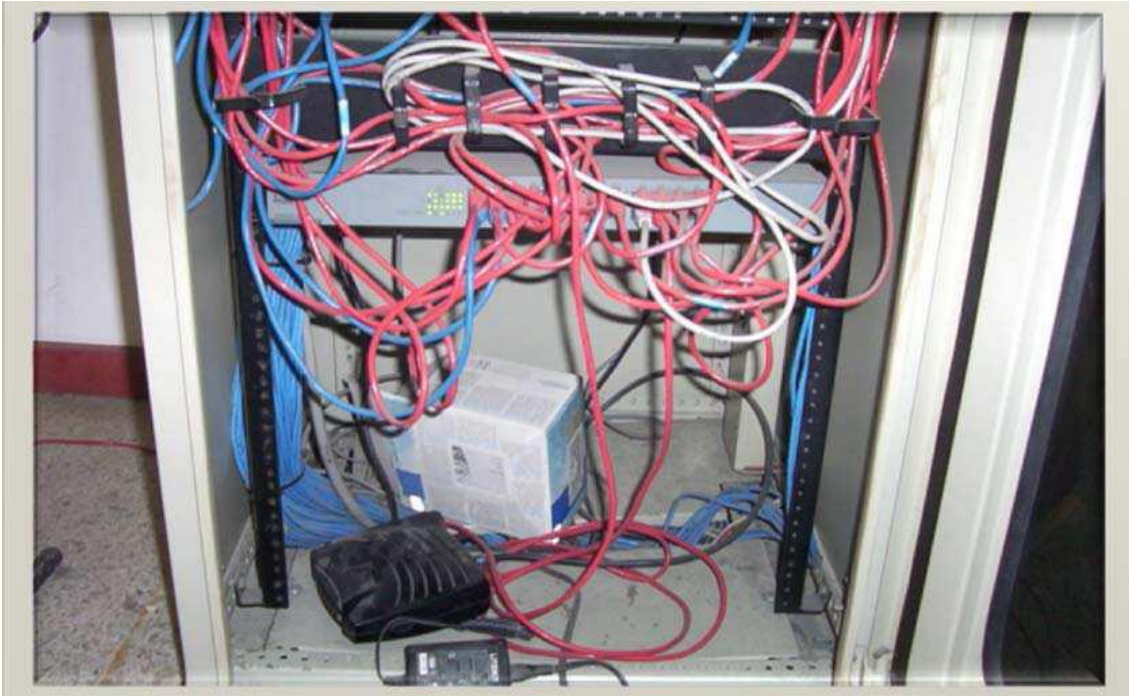
Figura 11. Rack de piso
