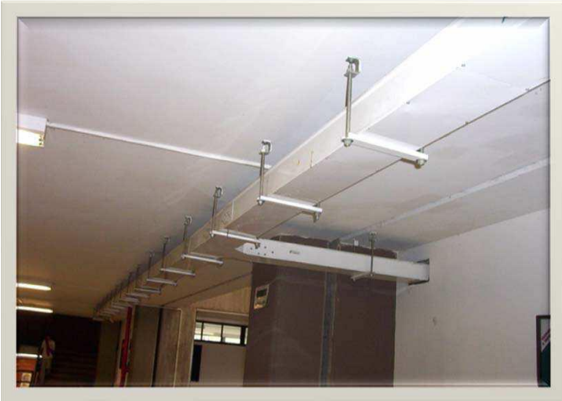
Figura 5. Distribución del cableado en bandeja cubierta
