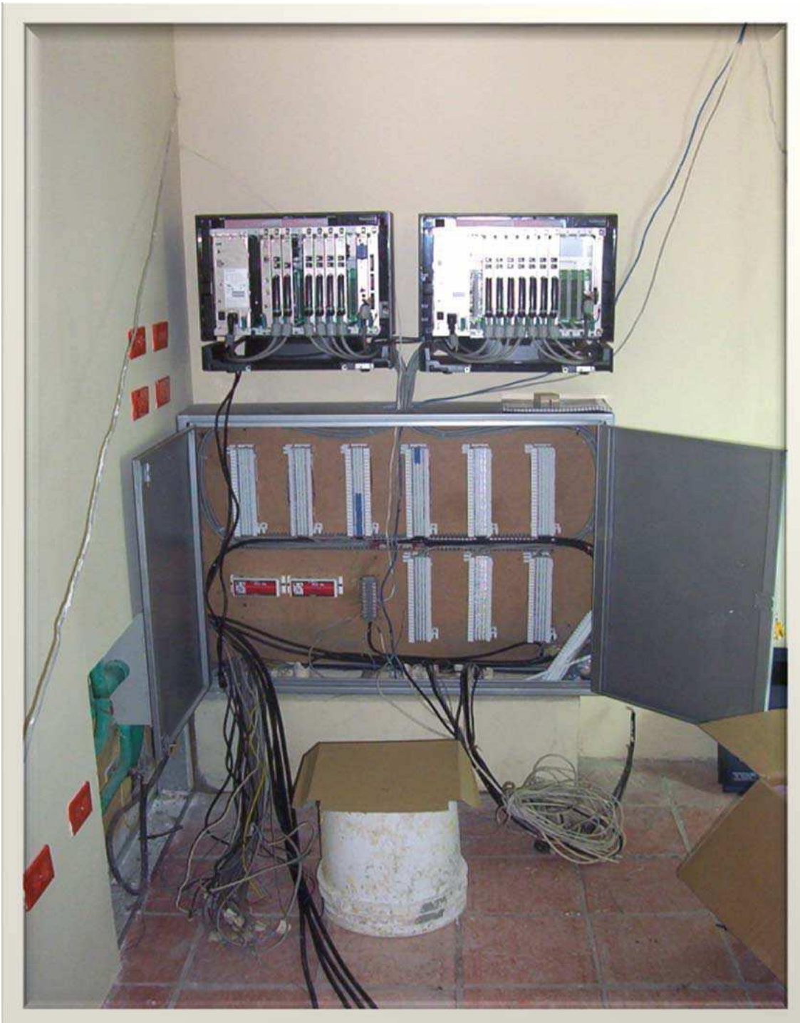
Figura 18. Centrales Telefónicas y Patch Panel
