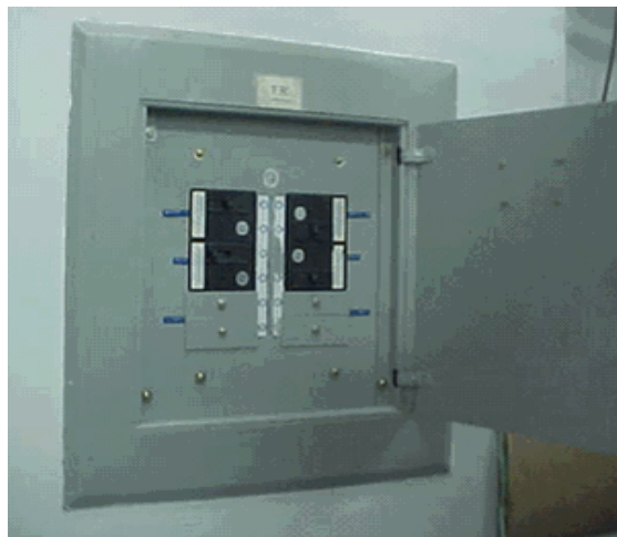
Figura 57. Tablero y protecciones contra sobrecarga
