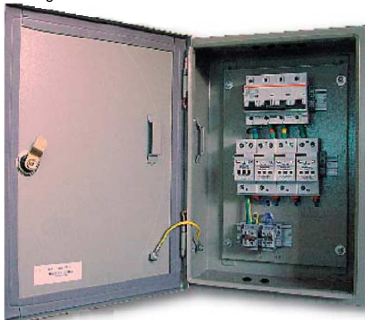
Figura 59. Tablero con las protecciones para sobrevoltajes
