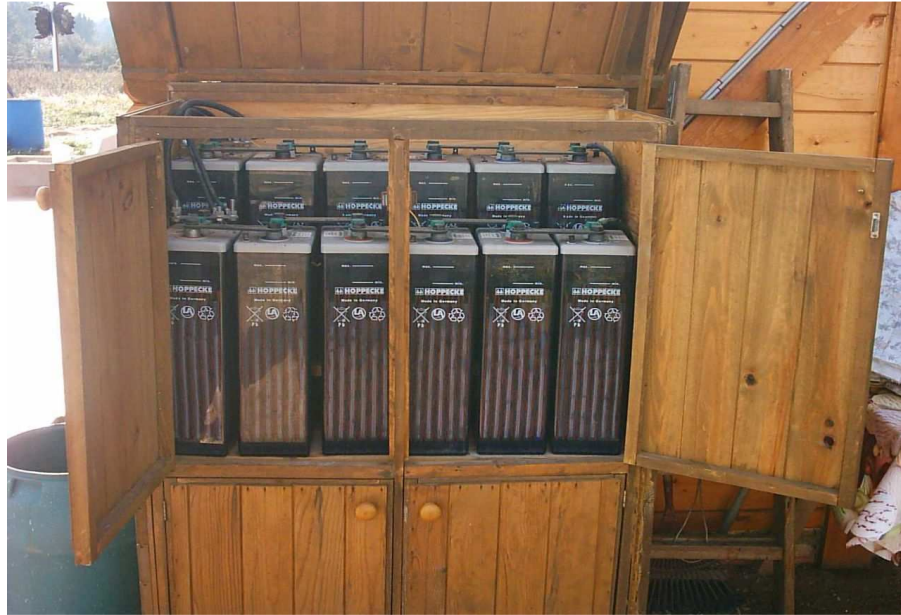
Figura 64. Banco de baterías
