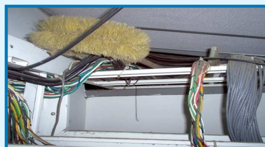
Figura 318-14 Mal uso de las bandejas portacables
