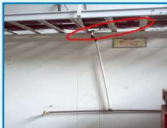
Figura 318-3. Uso incorrecto de las bandejas portacables 1
