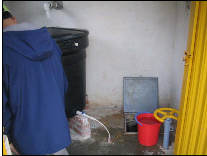
Figura 19. Tanque de almacenamiento acueducto Villa Nueva Bajo
