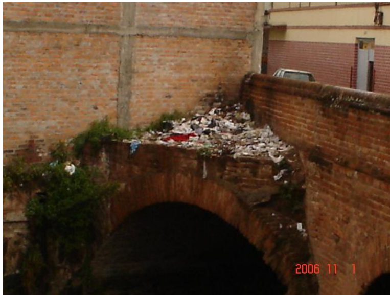
Figura N° 6. Disposición inadecuada de residuos sólidos
