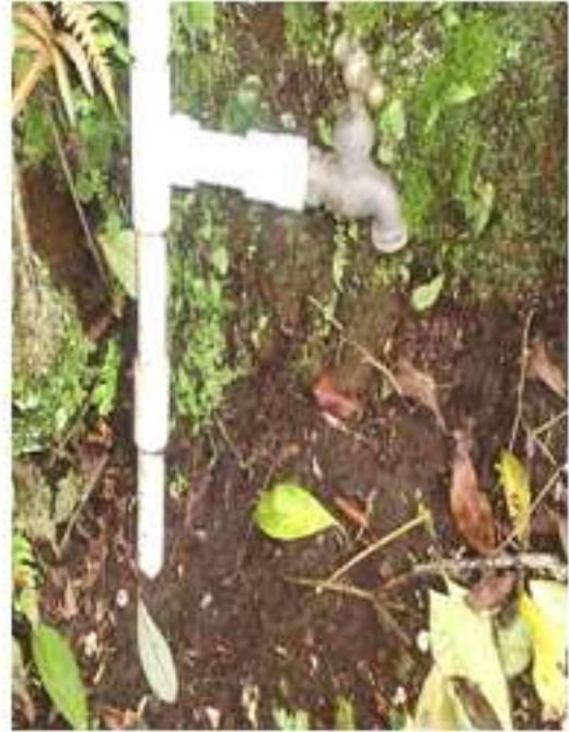
Tanque 5 (Condominio la Granja – La Gramínea)
