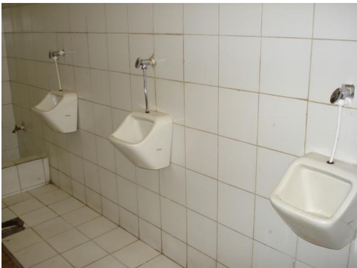
FOTO 3: Sistema de orinales usados en la cárcel
