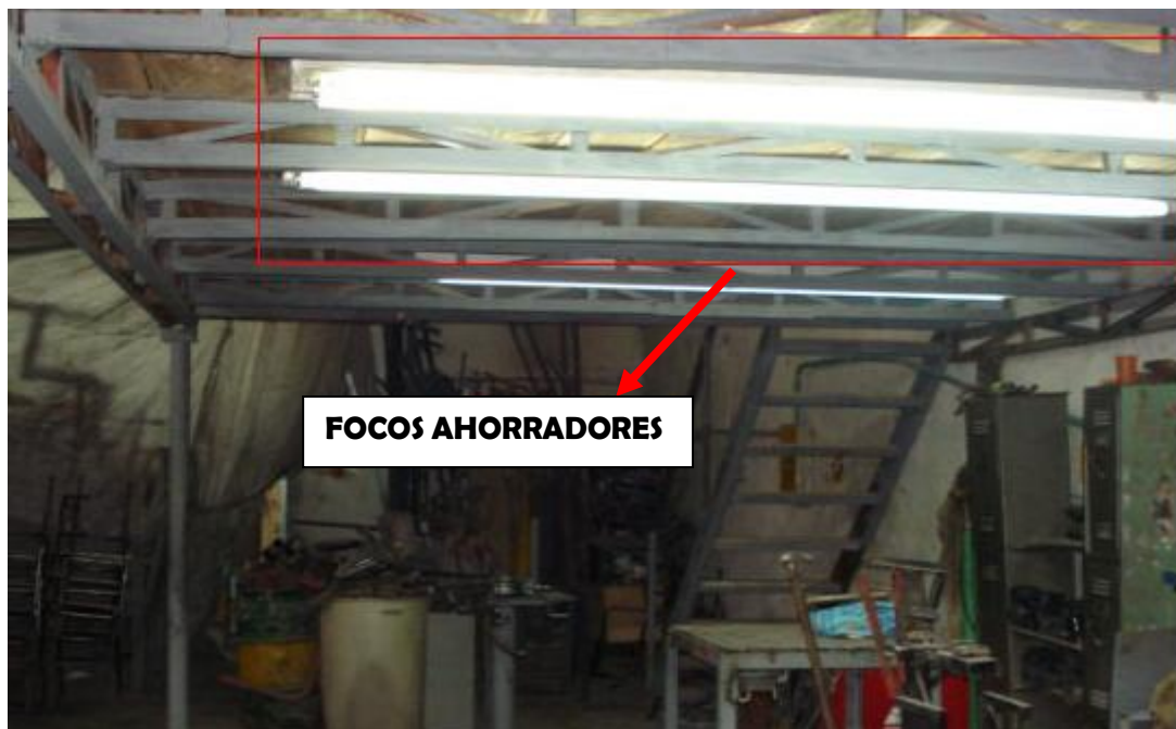
FOTO 18: Sistema de alumbrado dentro de la institución
