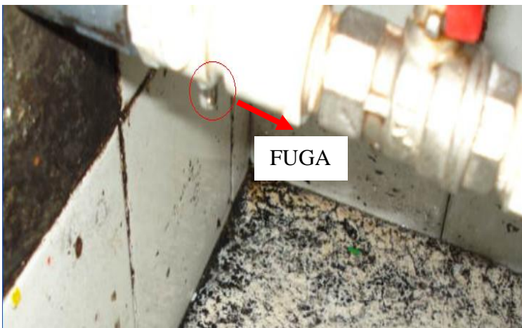
FOTO 6: Se puede ver una fuga en uno de los grifos
