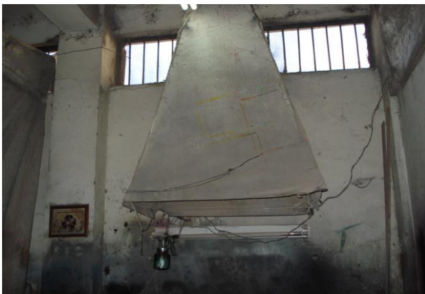
FOTO 9: Se muestra campana extractora en el área de pintura
