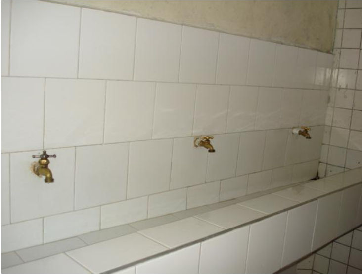
FOTO 1: Sistema de lavamanos de la institución
