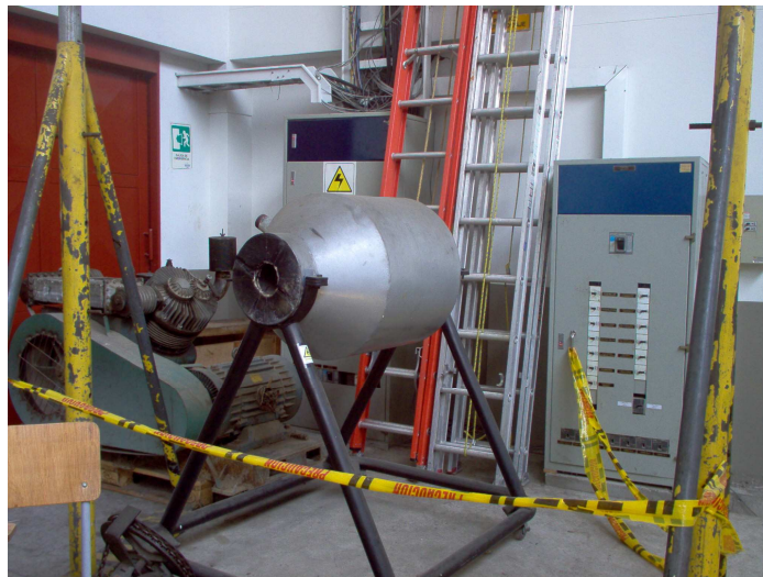
Figura 9. Subestación eléctrica (junio 2007)
