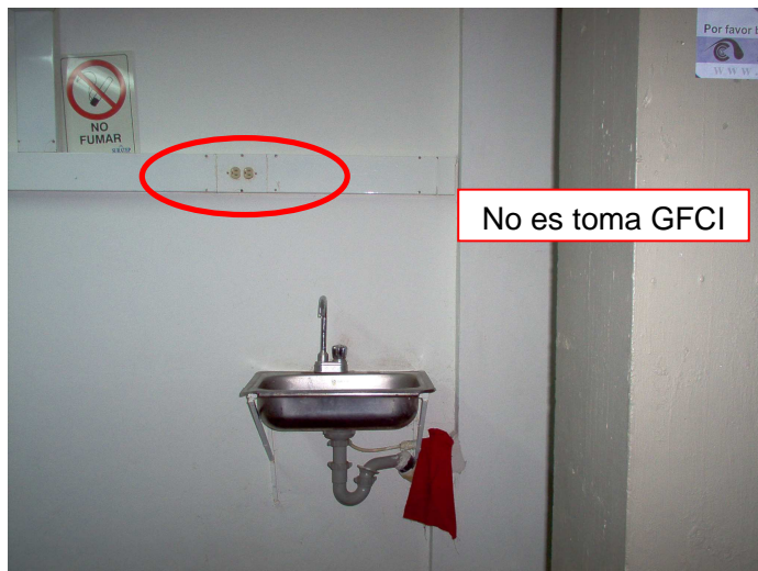
Figura 53. Laboratorio de térmicas
