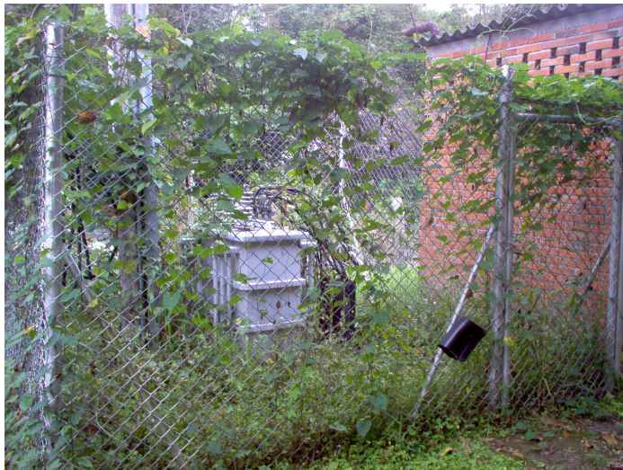
Figura 12. Cerramiento del transformador
