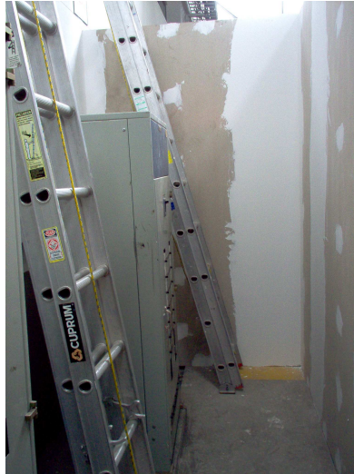
Figura 6. Subestación eléctrica y tablero taller principal
