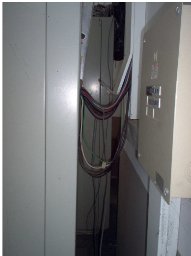
Figura 14. Posición del tablero subestación
