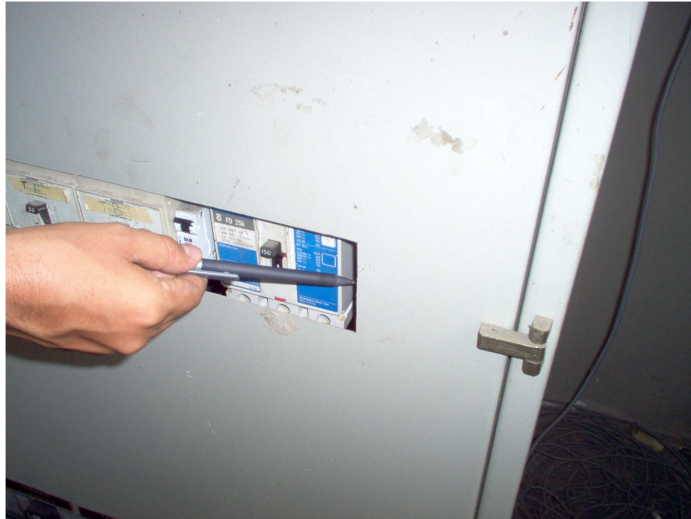
Figura 16. Tablero Subestación (abertura 2)
