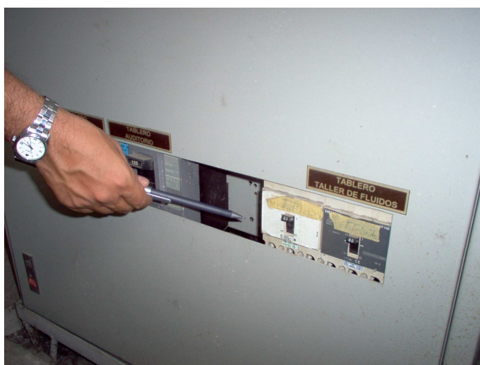
Figura 15. Tablero Subestación (abertura 1)
