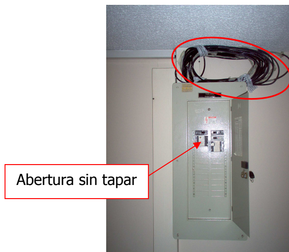
Figura 24. Tablero Laboratorio Térmicas
