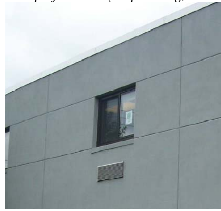
PTAC Exterior Grill
