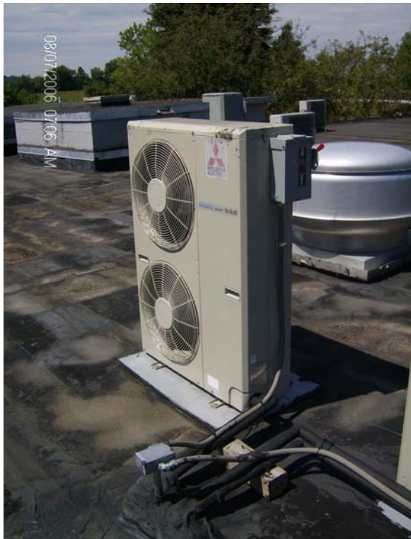
Mitsubishi Mini Split 1.5 ton Condensing Unit (AC11)
