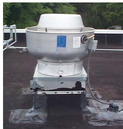
Typical Up Blast Fan
