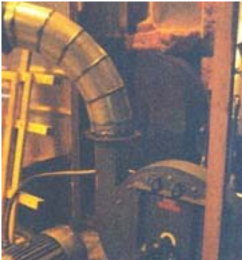
Photo No. 3. Fluidizing Air Fan
