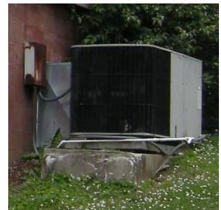
Fig. 61. Older, inefficient HVAC unit.
