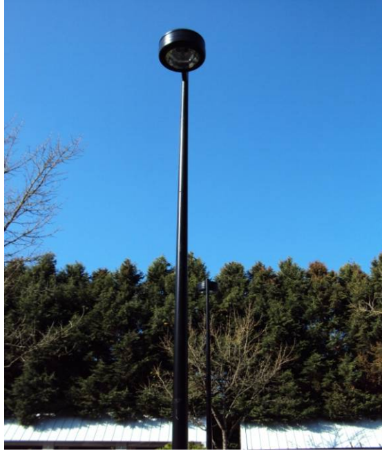
Figure 3.4. Original 400 W metal halide luminaire
