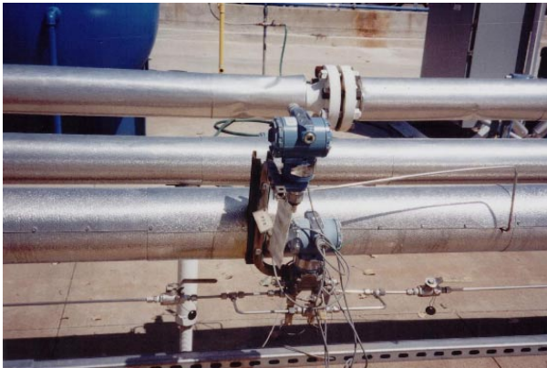
(d) Flow meter in outdoor flow loop
