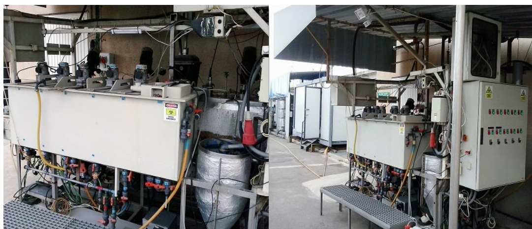
Figura 14. Planta piloto de fangos activados.
