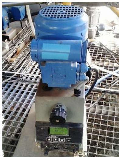
Figura 20. Bomba de recirculación.
