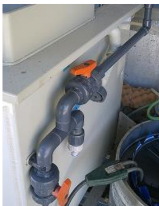
Figura 22. Válvulas y conducciones.
