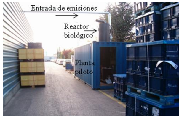
Figura 4.4. Fotografía del exterior de la planta piloto de biofiltro percolador (VOCUS®). Cortesía de FICOMIRROR S.A.
