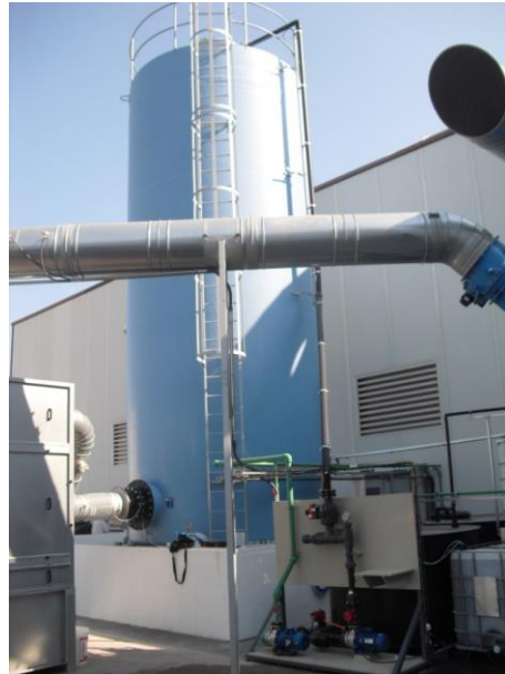
Figura 4.6. Fotografía del exterior de la planta industrial (VOCUS®). Cortesía de GAMADDECOR S.A. (Grupo Porcelanosa).
