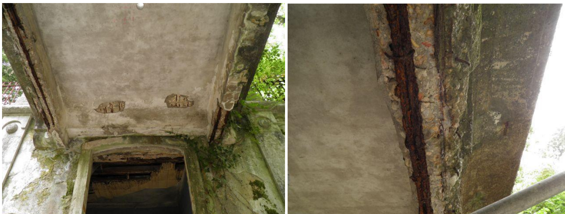
Figura 2-22 Passadiço - Vista parcial da zona inferior (Pormenor armadura oxidada)
