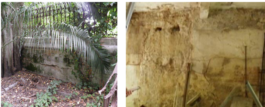
Figura 2-19 a) Fissura horizontal (vista exterior) b) Fissuras verticais e horizontas (interior) na parede lateral divisão A.
