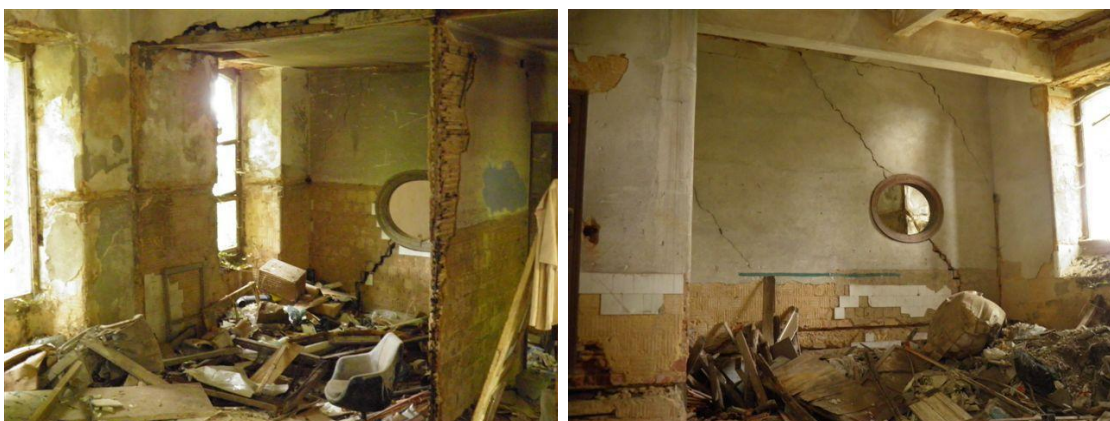
Figura 2-20 Fissuras oblíquas na parede de alvenaria de tijolo vistas nas duas divisões (divisão A e B)
