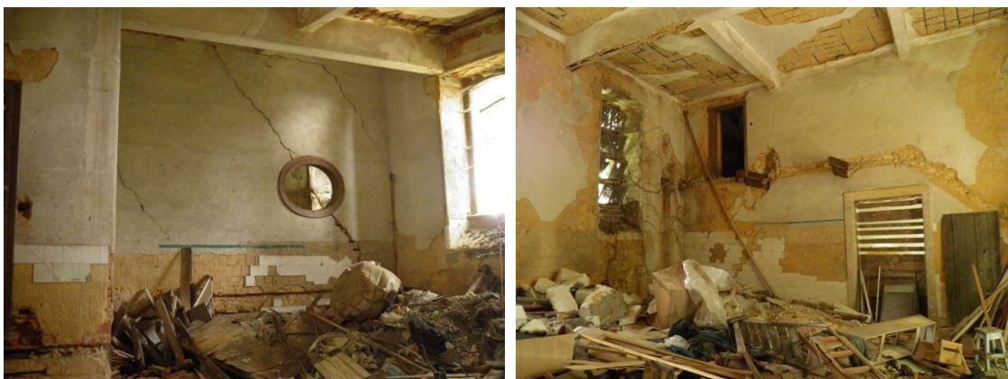
Figura 2-13 Divisão B – a) parede com óculo (A-B) b) parede meira (B-C)
