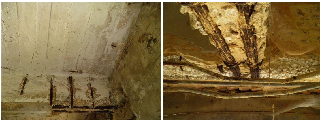
Figura 2-25 Ligação da viga à parede, com armadura exposta quer longitudinal quer os estribos; grupo de fios longitudinais, com estribos expostos
