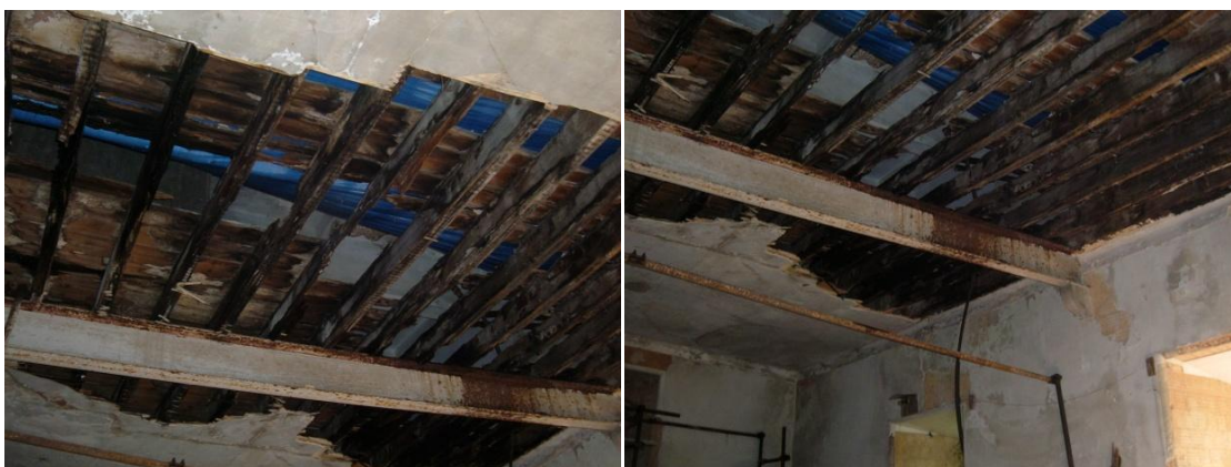
Figura 2-18 Teto de madeira e pormenor do cachorro de pedra que sustenta a viga metálica
