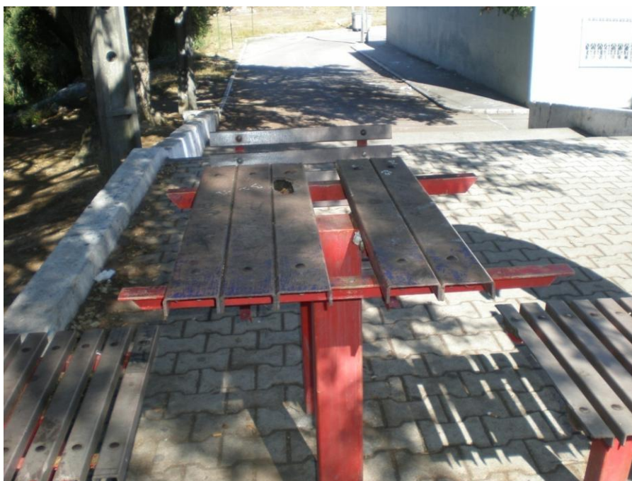
Imagem de mesa danificada existente no Parque Infantil do Bairro 1º de Maio
