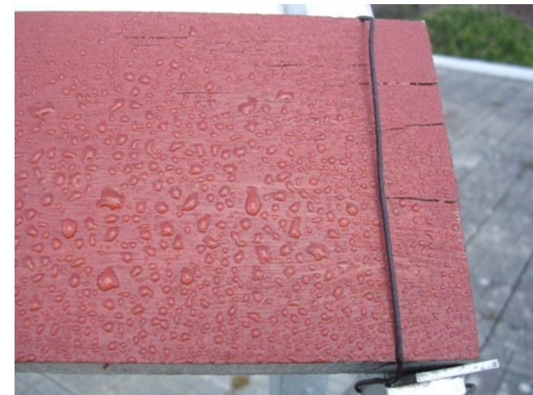
Fig. 21 - Solução de proteção com repelentes à água.
