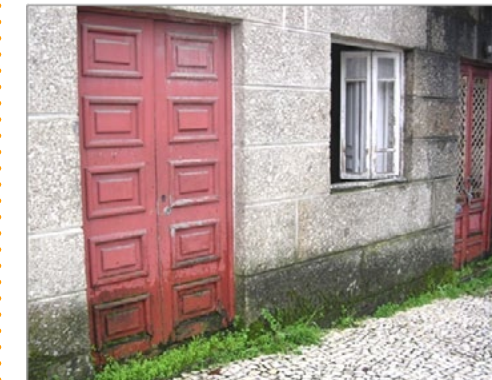
Fig. 4 - Efeito da degradação de uma porta de madeira pintada, em função da agressividade da exposição.
