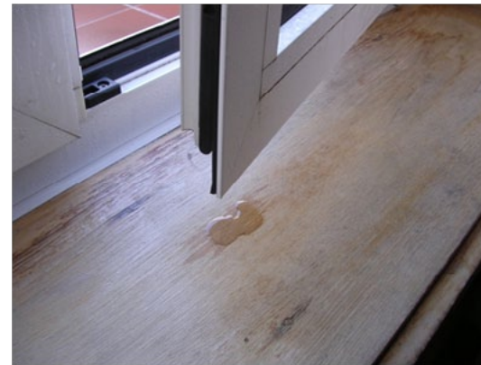
Fig. 7 - Efeitos da água num parapeito interior da janela de uma habitação.
