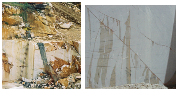
Figura 5 – (A) Intercepção de um filão pela indústria extractiva; (B) Água subterrânea a circular por fracturas interceptadas numa frente de exploração de rocha ornamental.
