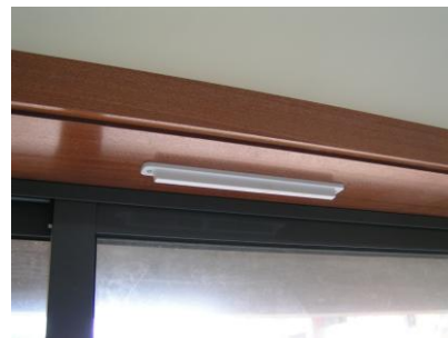
b) Grelha auto-regulável instalada nos quartos e sala
