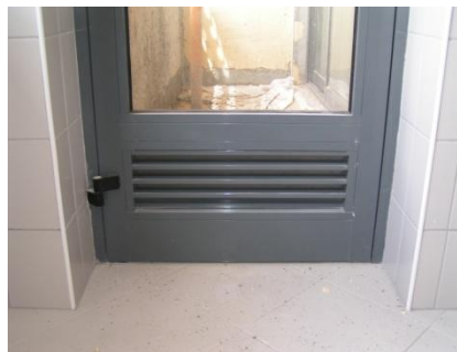
Grelha instalada na porta exterior da cozinha
