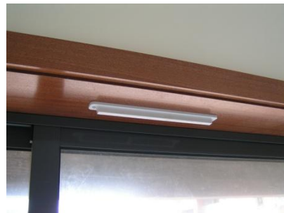
Grelha auto-regulável instalada nos quartos e sala
