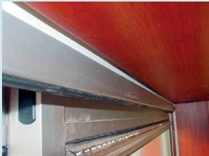
a) grelha de admissão fixa instalada na caixilharia
