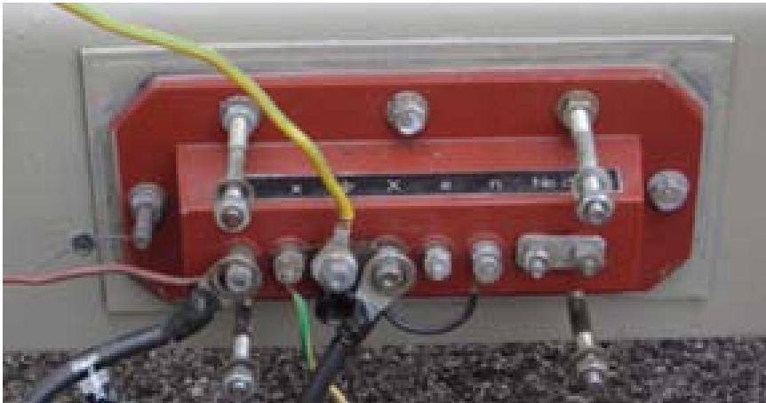
Slika 16: Priključna omarica visokonapetostnega merilnega transformatorja VPU-123
