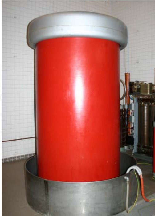
Slika 4: Enofazni visokonapetostni transformator
